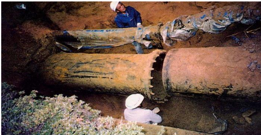
Figura 1.1: sfilamento di un giunto in una condotta in occasione del terremoto di Kobe del 1995. Fonte: H.Fukuda "Damages in the KOBE Earthquake & Japanese Seismic Design Guidelines of Drinking Water Supply Facilities"
