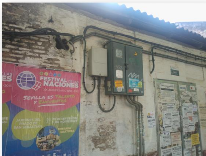
Immagine del quartiere: impianti elettrici ad altezza d'uomo non protetti né segnalati. Fonte: scatto a cura dell'autore, anno 2013
