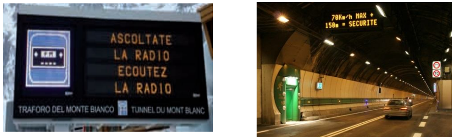
Figura 67: Pannelli a messaggio variabile reperibili all'ingresso e all'interno del traforo
