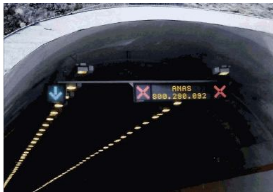
Figura 28: esempio di semaforo e pannello a messaggio variabile posizionati all'imbocco di una galleria stradale
