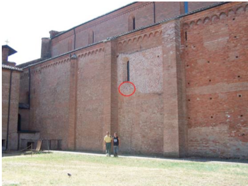
Figura 4.6 - Posizione del termo-igrometro su un lato dell'abbazia(Fonte: Studio del fenomeno dell'isola di calore su un'area urbana di piccole dimensioni, ARPA Emilia Romagna)
