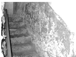
Fig. 73 - Efflorescenze saline che determinano uno stato di degrado avanzato in una muratura storica
