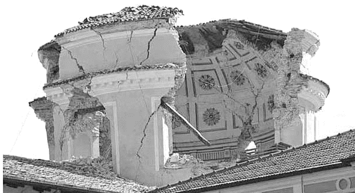
Fig. 85 - Foto della cupola della chiesa di Santa Maria del suffragio a L'Aquila dopo il sisma del 2009
