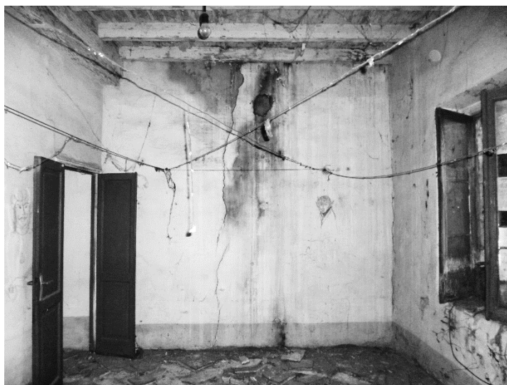
Fig. 167 - Interno di una stanza al piano primo del corpo A giustamente utilizzata come stenditoio. Sullo sfondo una bella doppia fessura sub-verticale.
