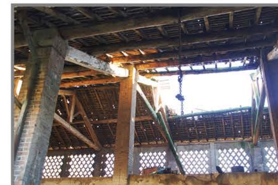
5 - Crollo della copertura
