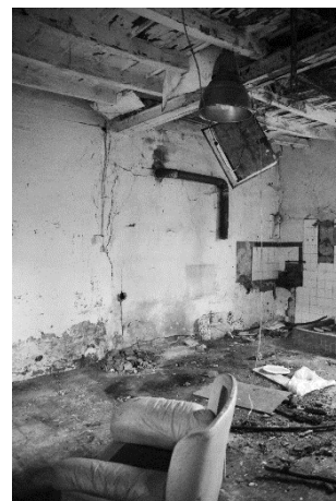
Fig. 149 - Foto di un locale al piano terra, corpo A. Si nota una profonda crepa che attraversa tutta la parete in tutt'altezza.
