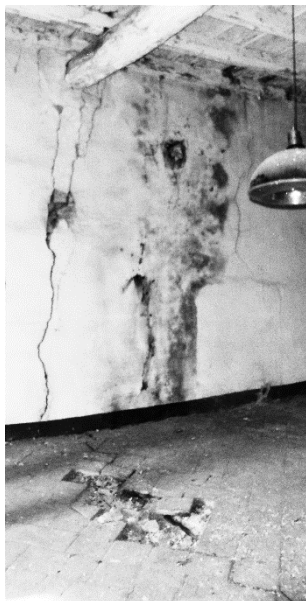
Fig. 151 - Importante crepa che interessa una parete di mezzeria e la parte di solaio limitrofa.
