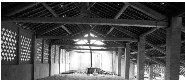
Fig. 140 - Vista prospettica del solaio superiore della stalla con la successione di capriate. Le macerie al centro derivano dal crollo di una parte della copertura.
