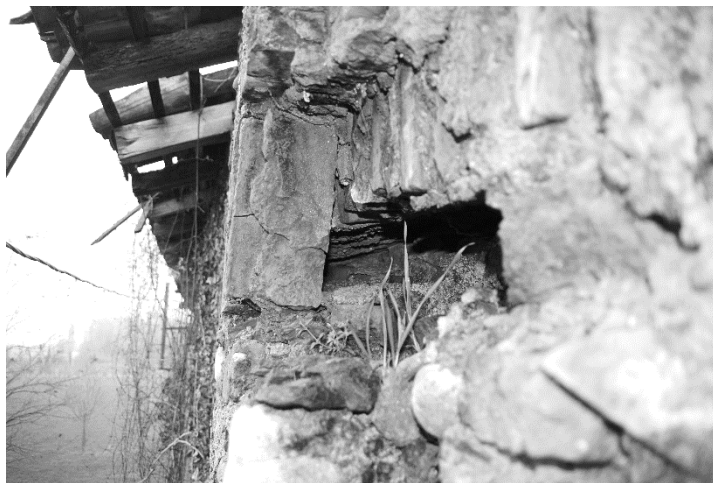
Fig. 161 - Fotografia che ritrae la tecnologia costruttiva con la piattabanda di mattoni bene in vista e vista dei degradi della copertura e della parete. Foto scattata sul prospetto nord
