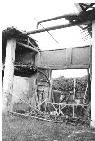
Fig. 139 – Foto della parte di copertura crollata del corpo B. Si può notare come una trave sia ancora in posizione.
