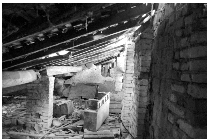
Fig. 138 - Foto del sottotetto del corpo A. Si vedono sulla sinistra le travi che costituiscono l'orditura primaria del tetto, a sostegno dell'orditura secondaria composta da travetti e listelli. La luce filtrante dal colmo lascia intendere i problemi di impermeabilizzazione del manto di copertura.
