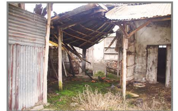
5 - Crollo della copertura
