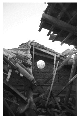
Fig. 141 - Foto che riprende la parte di copertura crollata del corpo E.
