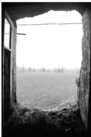
Fig. 162 - Suggestiva vista da uno dei locali al piano primo del corpo residenziale. Un serramento è stato divelto lasciando libera la visuale sul parco a nord di pertinenza della cascina.
