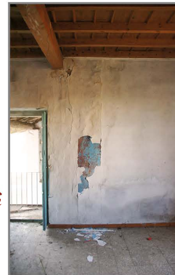
5 - Dettaglio crepa piano primo
