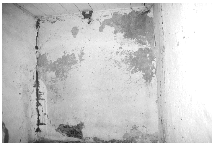
Fig. 164 - Foto scattata dall'interno del vano scala del corpo A. Ben visibili le zone di disgregazione dell'intonaco e, in basso a sinistra, una mancanza nello strato di finitura.
