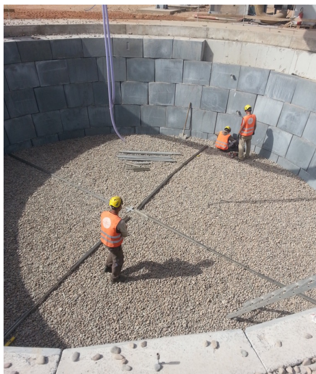
Figura 2.13: Serbatoio a termoclino presso l'impianto AirLight
