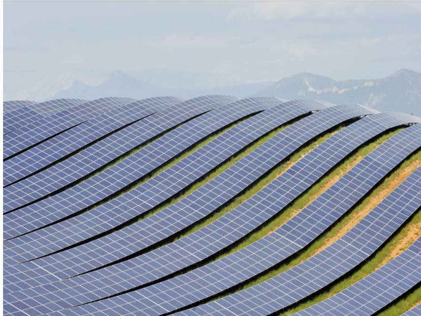
Figura 1.4: Impianto fotovoltaico su terreno collinare
