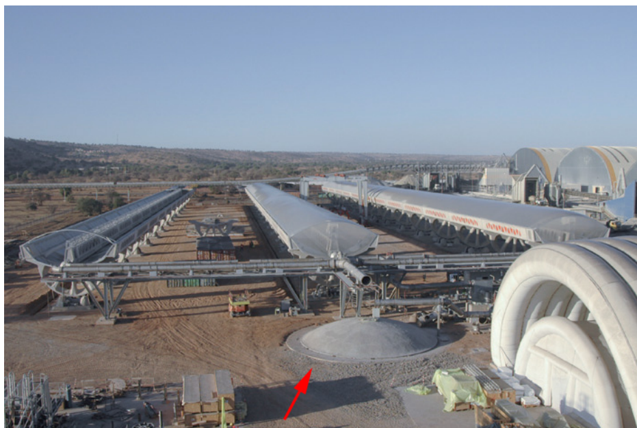
Figura 2.12: Collettori solari e in basso il serbatoio di accumulo termico presso l'impianto AirLight
