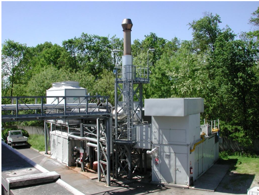
Figura 1.1. Foto della zona di trigenerazione scattata dal terrazzo dell'edificio G2.
