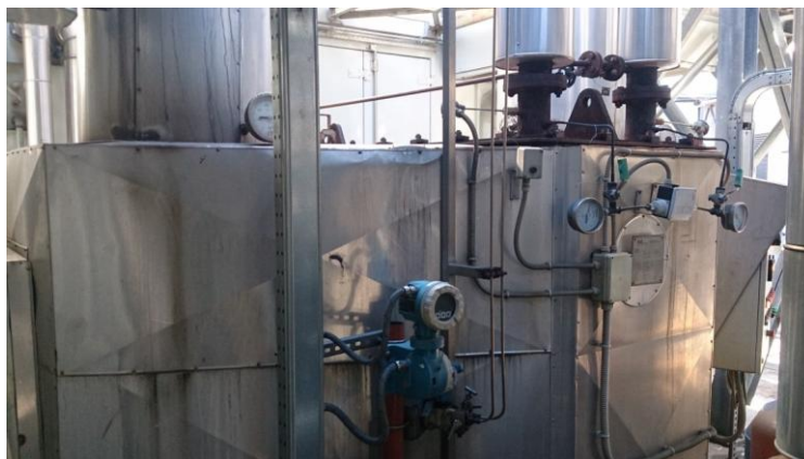
Figura 3.3. Foto della caldaia a recupero olio – fumi SIAT presente nell'area di trigenerazione.
