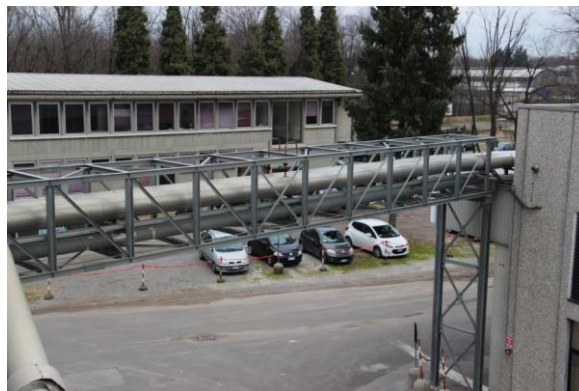
Figura 6.7. Foto della struttura di sostegno alle tubazioni presente presso lo stabilimento.
