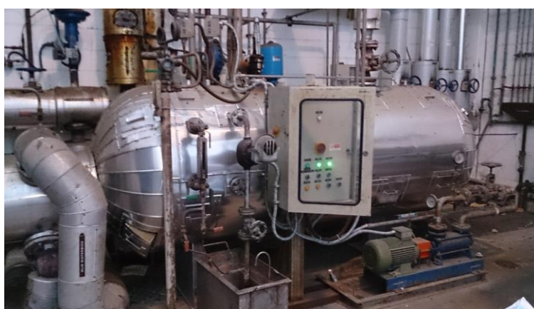
Figura 3.4. Foto dell'evaporatore ad olio diatermico scattata all'interno della centrale termica di G2.
