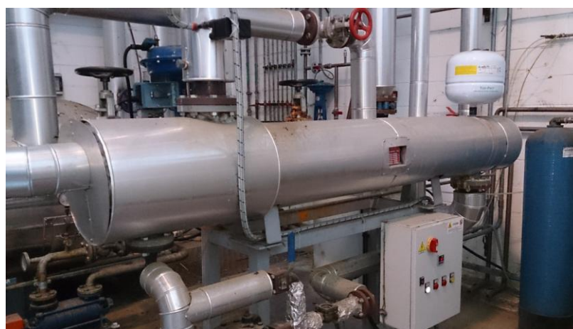
Figura 3.5. Foto dello scambiatore Vapore - Acqua presente nella centrale termica di G2.
