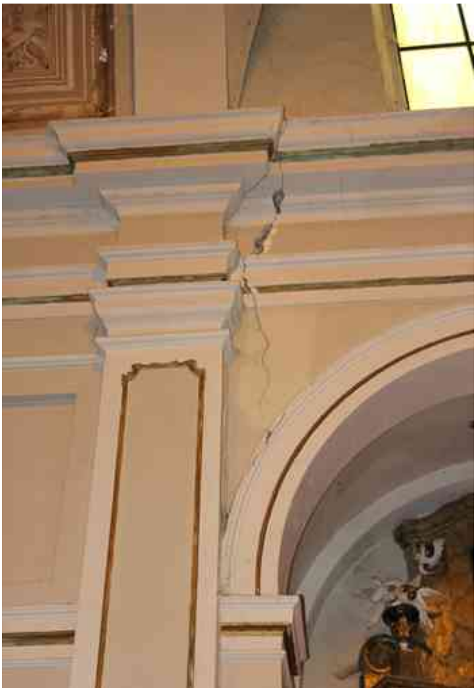
Figura n°89: Lesione verticale in corrispondenza di una cappella laterale.
