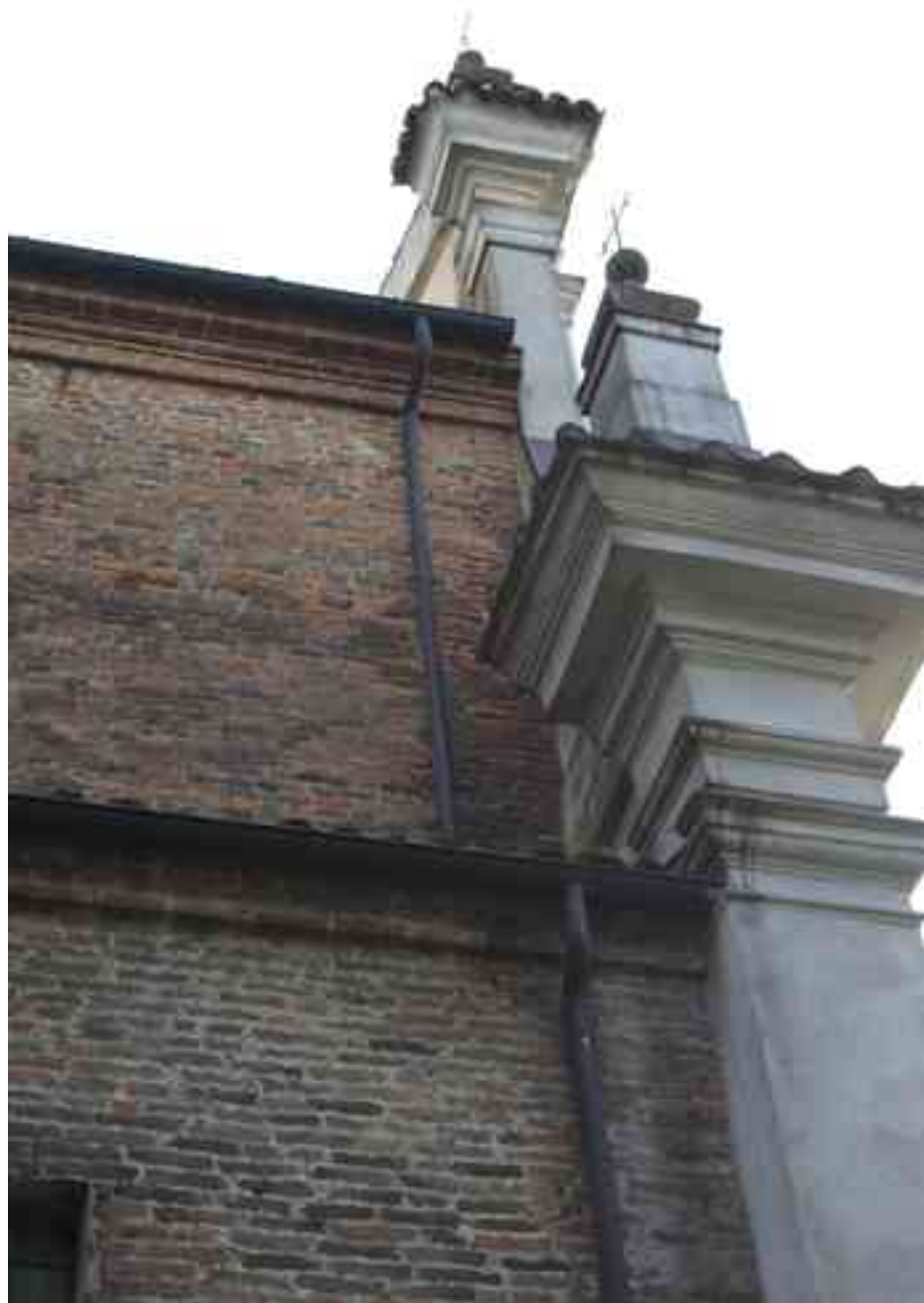
Figura n°80: Ribaltamento parziale della facciata dal corpo principale, prospetto nord.
