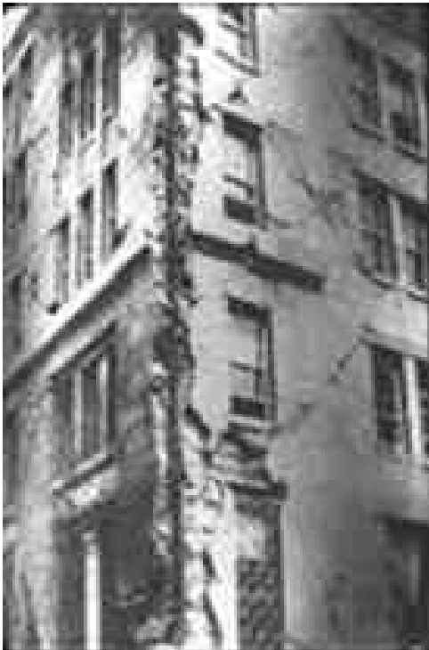
Figura n°6: Effetti del terremoto su un edificio in muratura, Yurak Building, Tokyo, Japan earthquake 1 sett. 1923.
