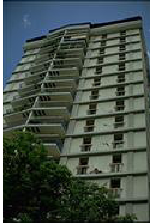
Figura n°7: Effetti del terremoto su un edificio in c.a. con tamponamenti in muratura, Blu Palace, Caracas, Venezuela earthquake 20 luglio 1967.
