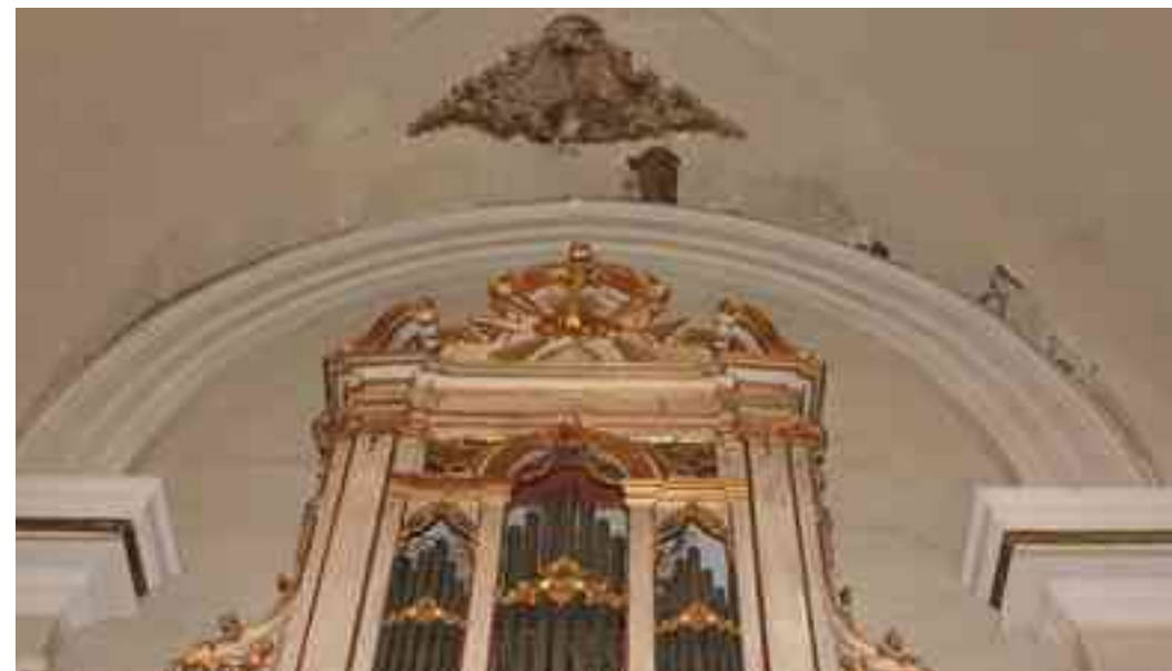
Figura n°85: Ribaltamento parziale della parte sommitale della facciata visto dall'interno.
