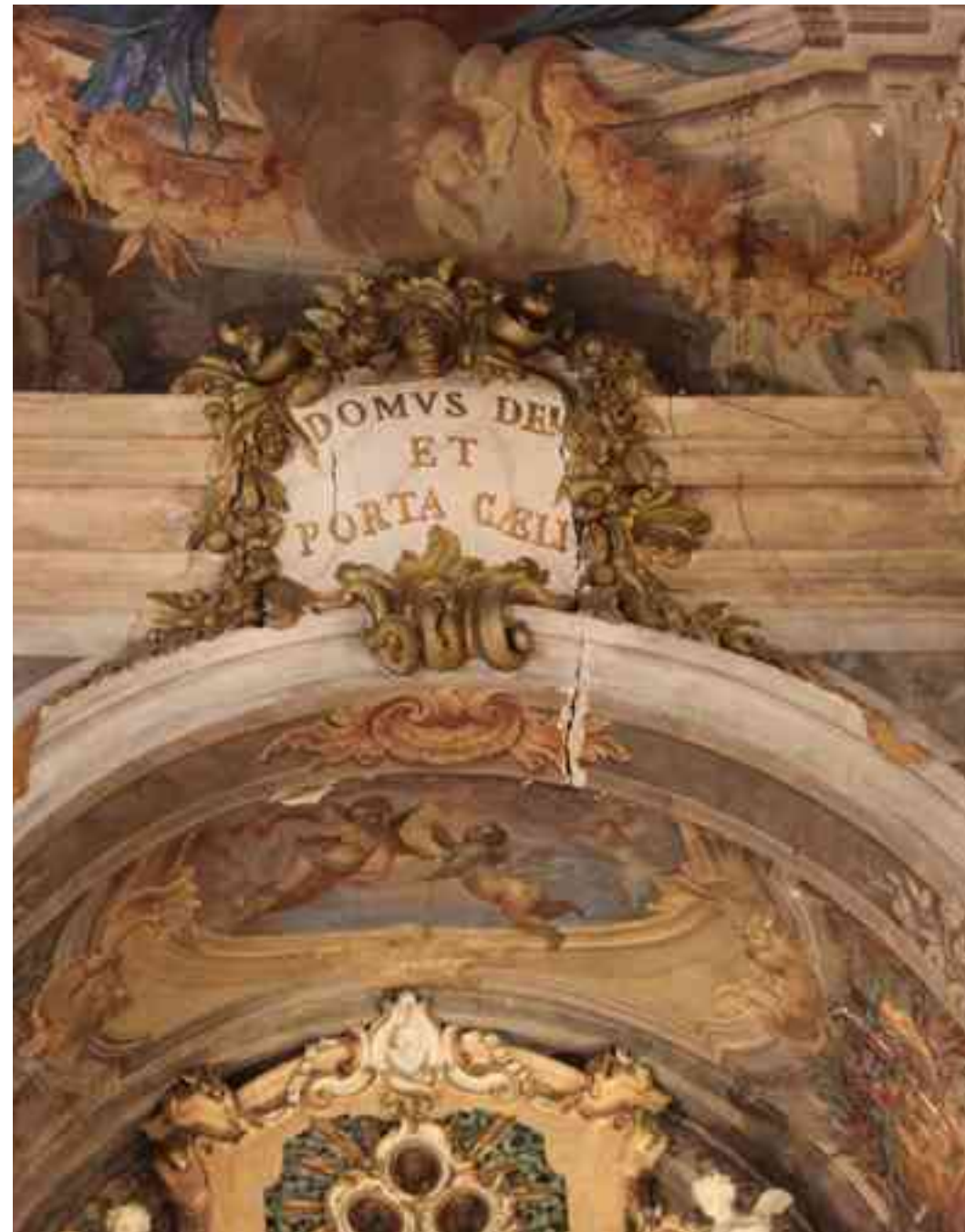
Figura n°72: Cedimento dell'arco di una delle cappelle laterali.
