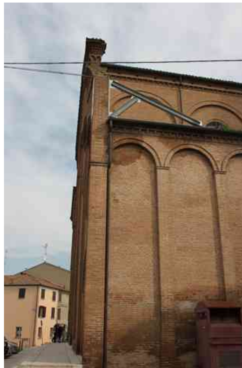
Figura °66:Opera di messa in sicurezza per il distacco della facciata dal corpo centrale.
