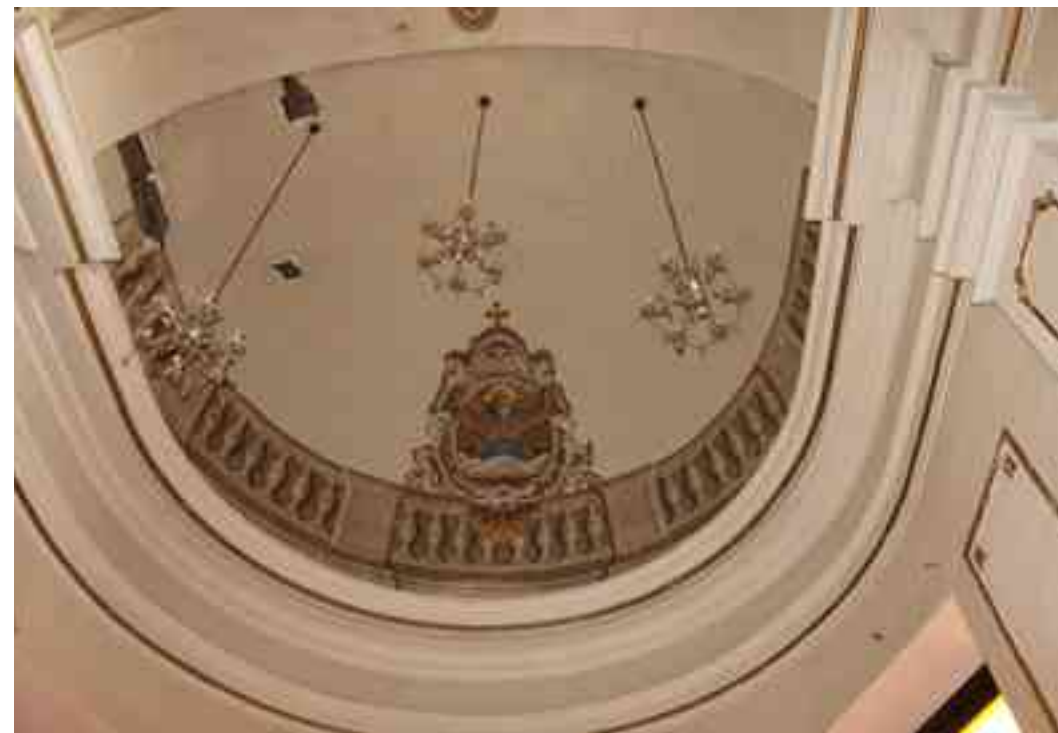
Figura n°96: Danni riscontrati sul soffitto.
