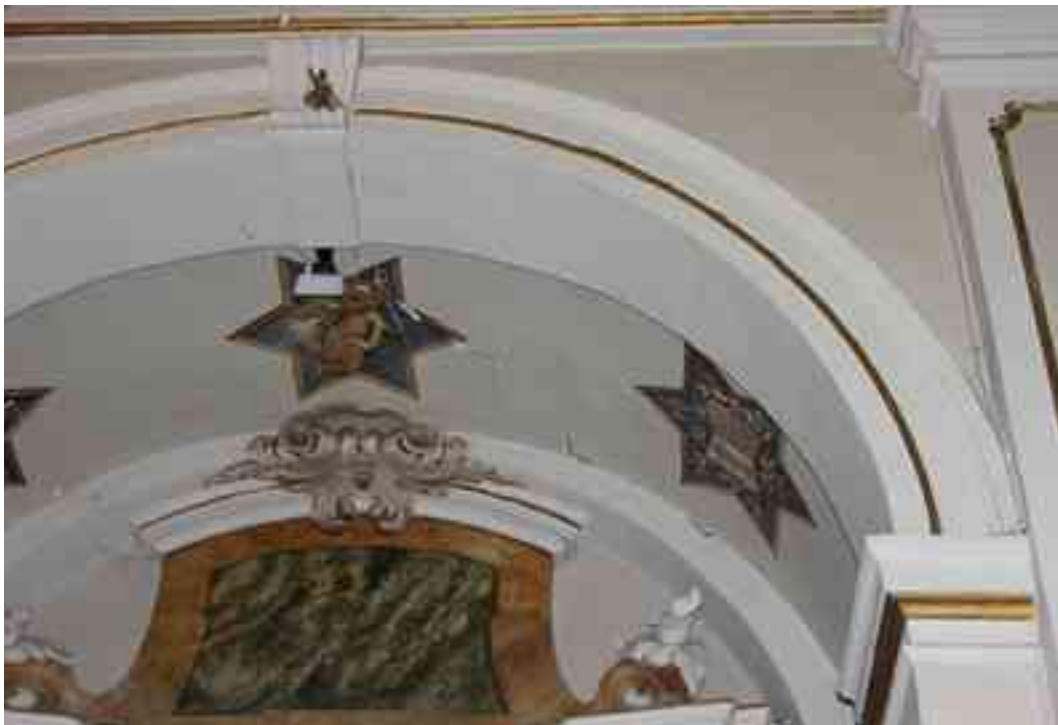
Figura n°91: Lesione in corrispondenza di una cappella laterale.
