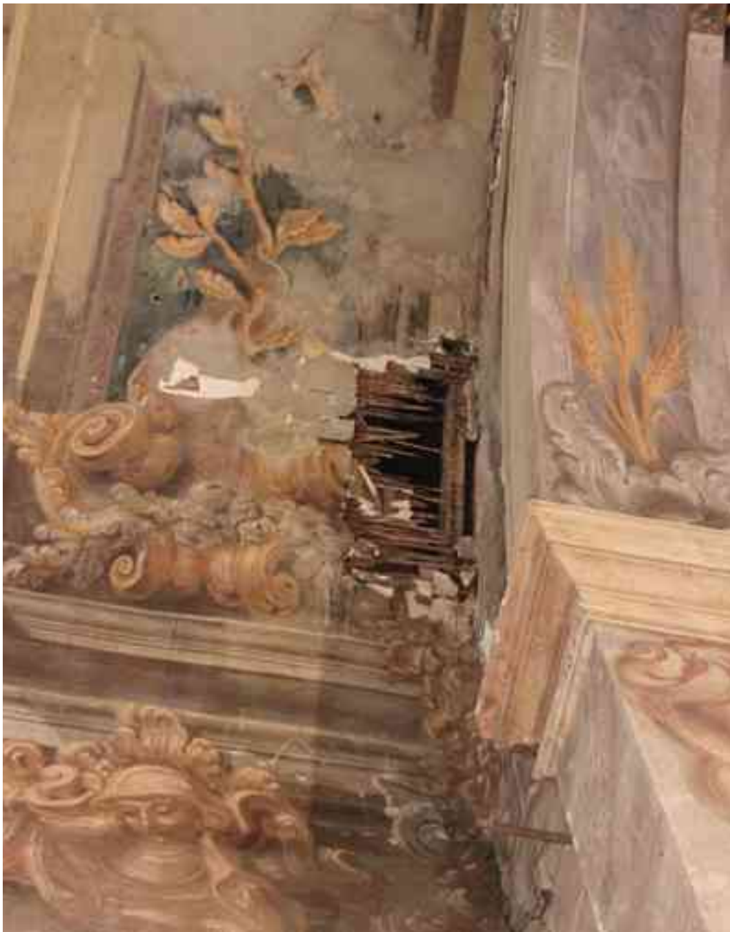
Figura n°71: Distacco dell'intonaco affrescato che lascia intravedere il controsoffitto in arelle.
