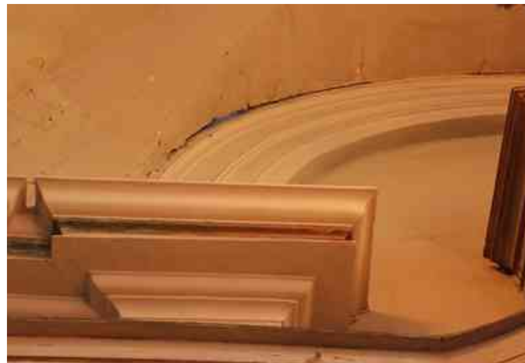
Figura n°86: Fessura da dove entra luce dall'esterno.
