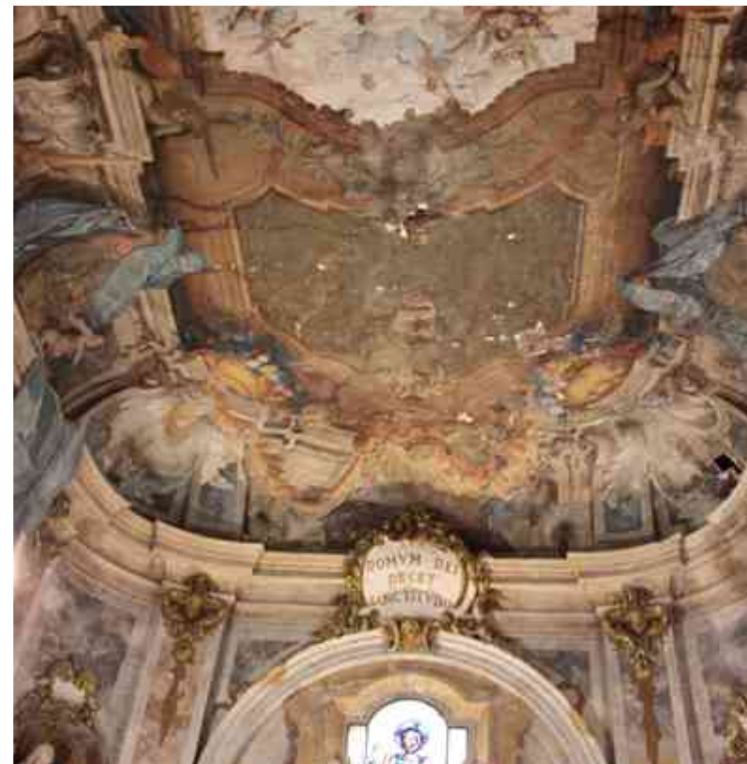
Figura n°70: Rigonfiamento del soffitto.
