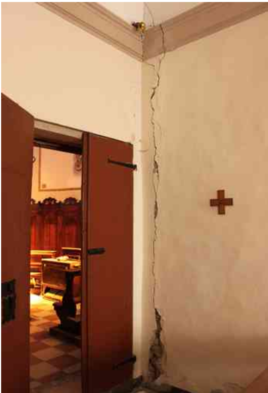
Figura n°87: Ribaltamento globale della cappella laterale del prospetto sud.
