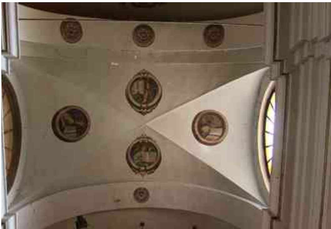
Figura n°95: Danni riscontrati sul soffitto.
