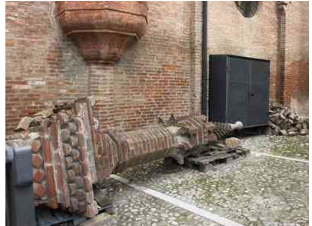
Figura n°64: Uno dei cinque pinnacoli crollati durante il terremoto.
