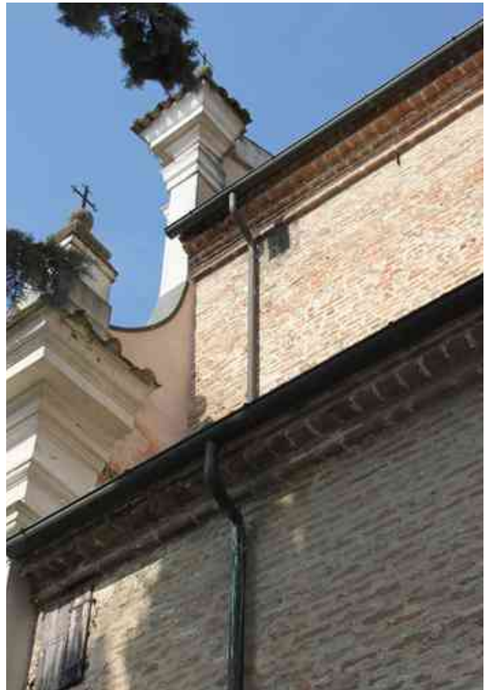
Figura n°81: Ribaltamento della facciata dal corpo principale, prospetto sud.
