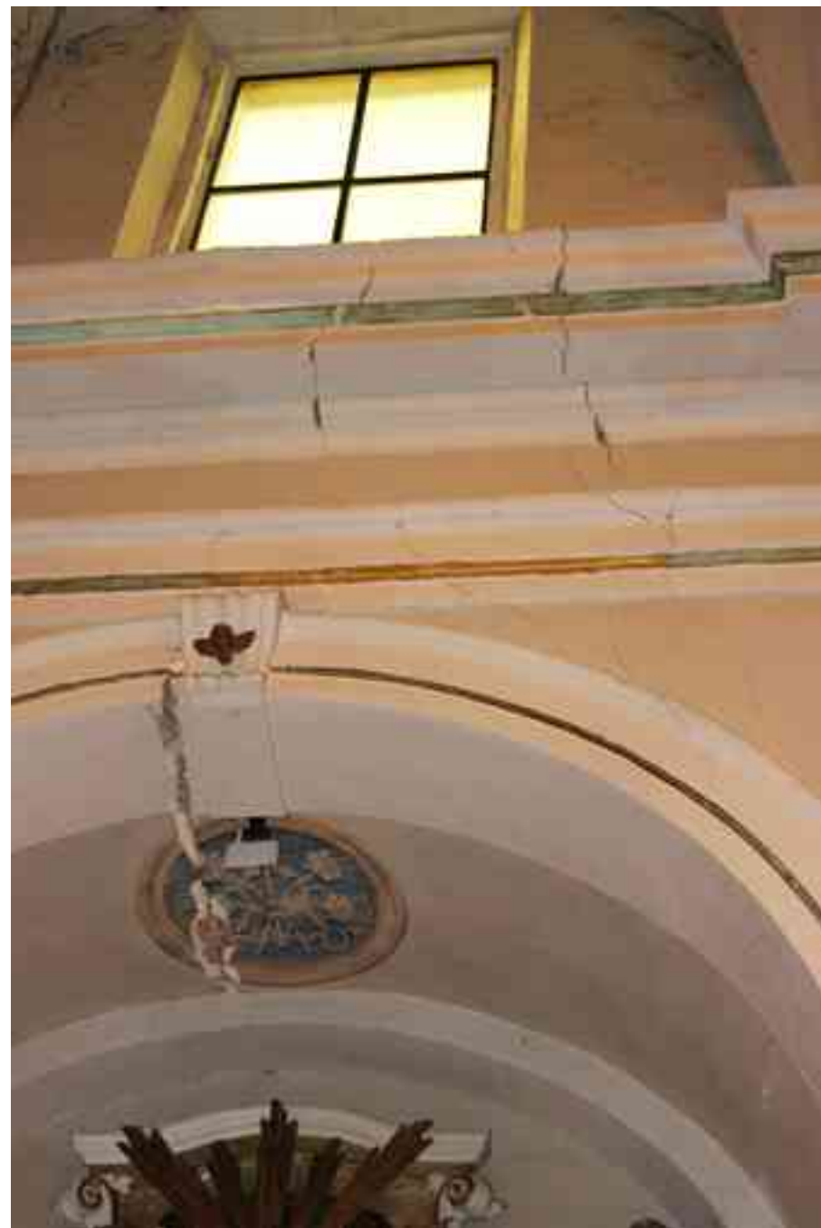
Figura n°90: Lesione verticale in corrispondenza di una cappella laterale.
