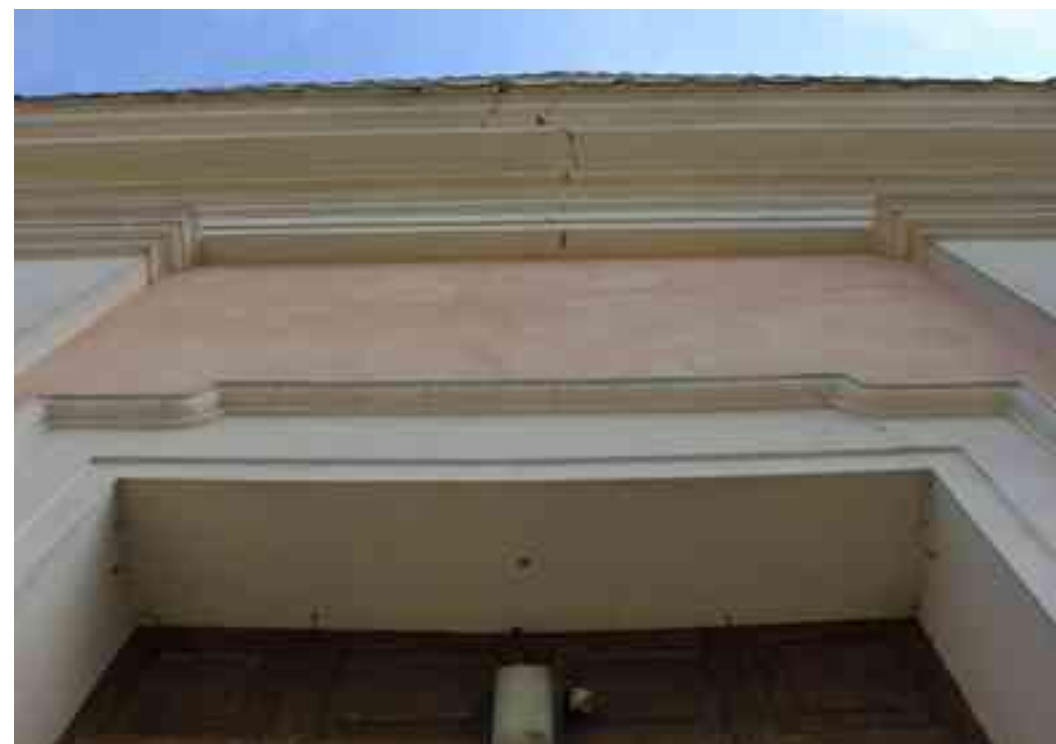
Figura n°79: Lesione verticale della facciata principale, vista da basso.
