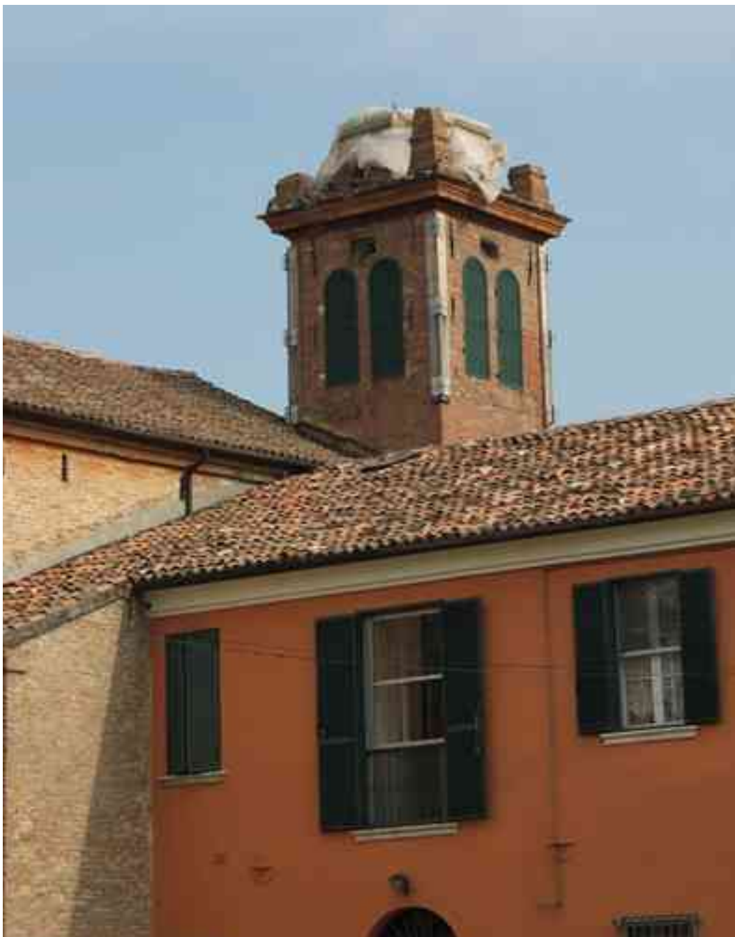
Figura n°69: Crollo della parte sommitale del campanile.
