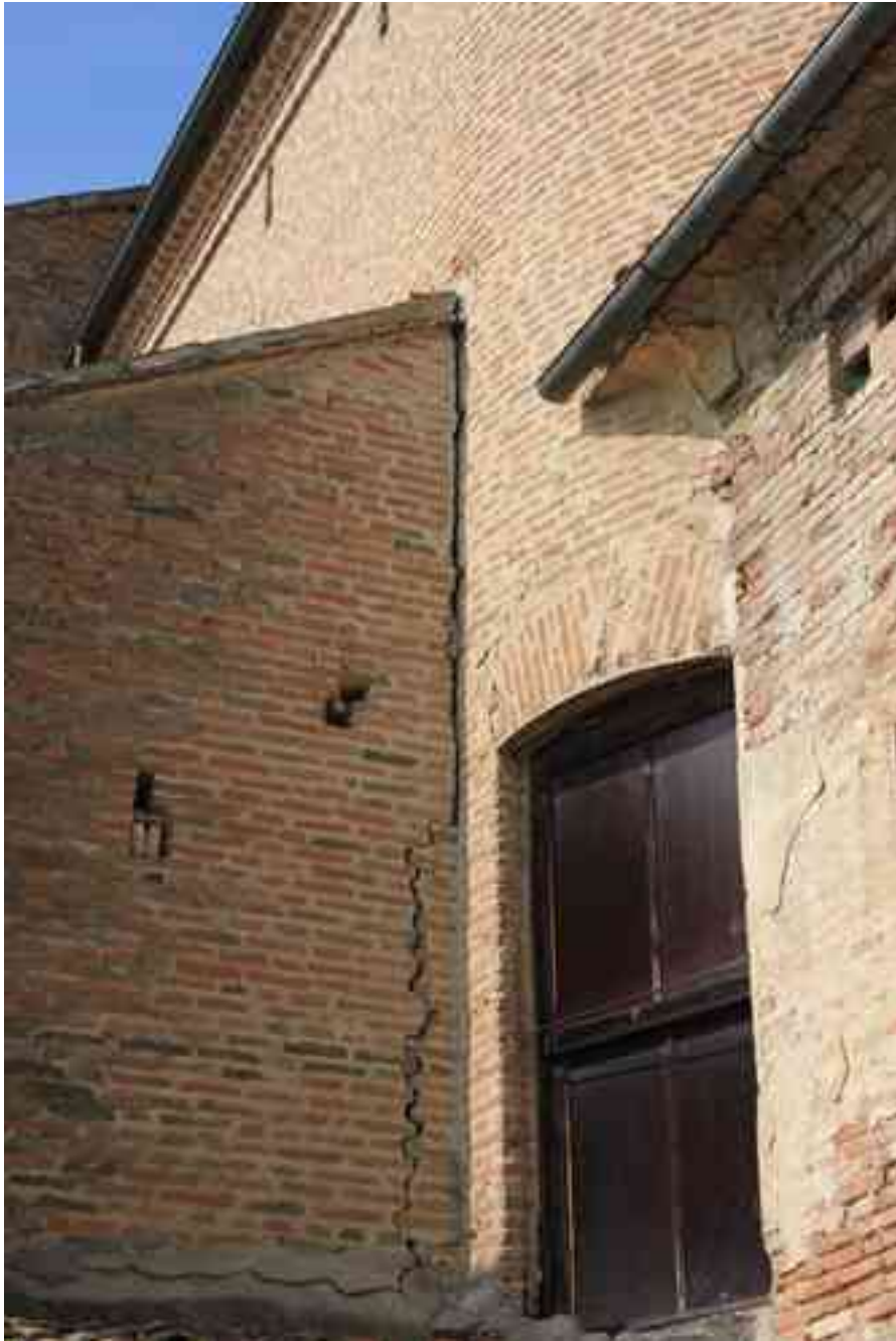
Figura n°82: Ribaltamento globale di una delle cappelle laterali del prospetto sud.
