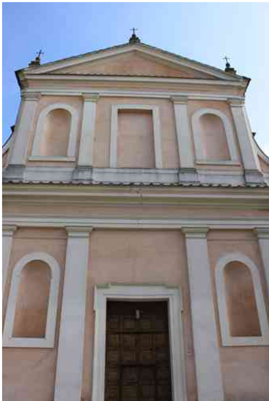
Figura n°78: Lesione verticale lungo la facciata principale.
