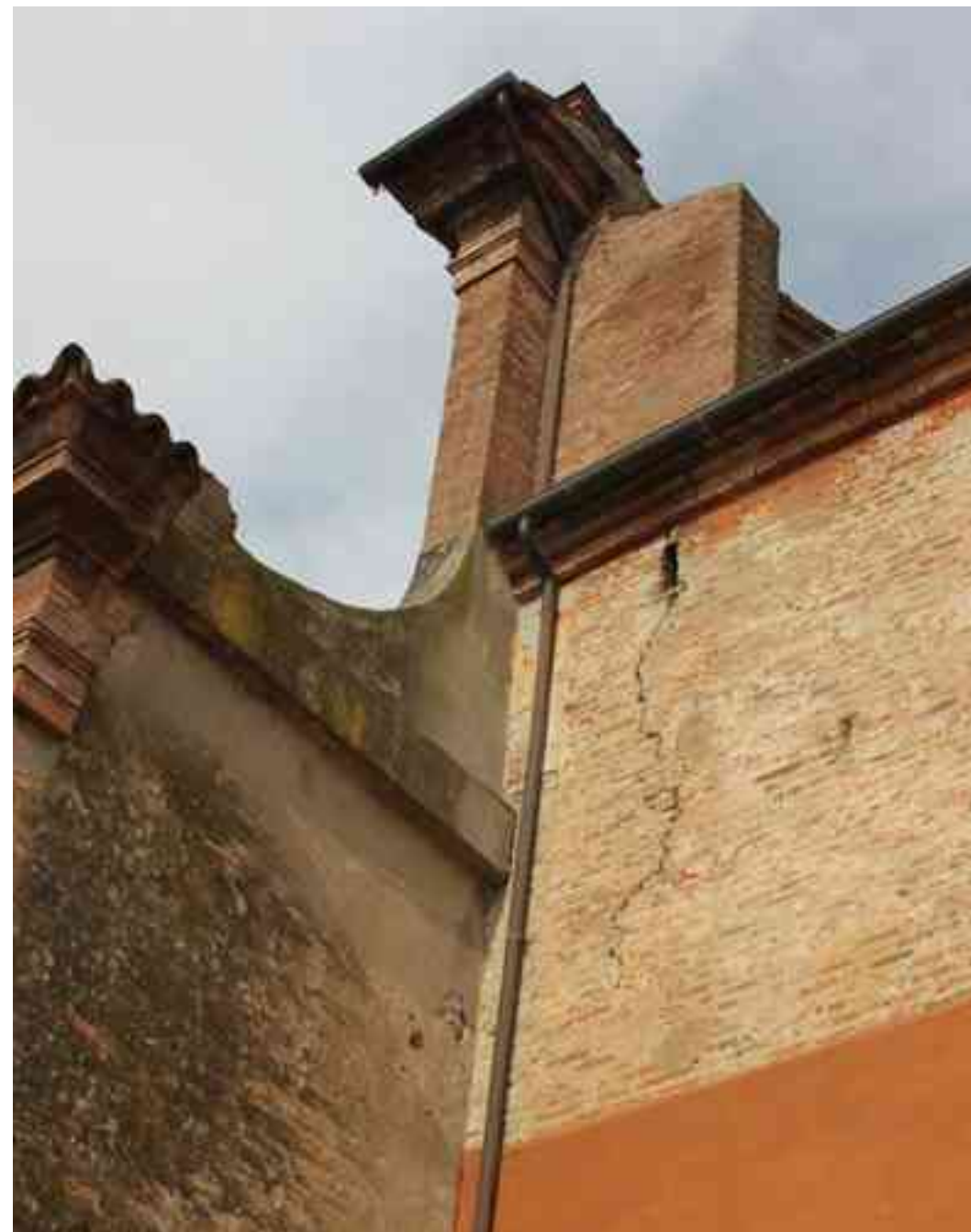
Figura n°68: Fessura verticale che indica il distacco della facciata dal corpo principale.
