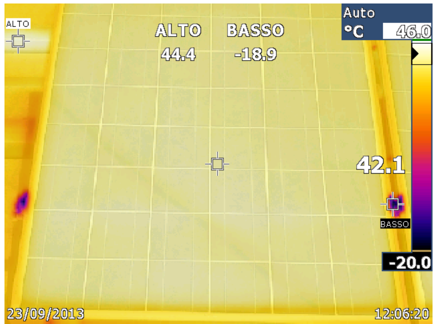
Figura 50. Foto termica ore 12.00
