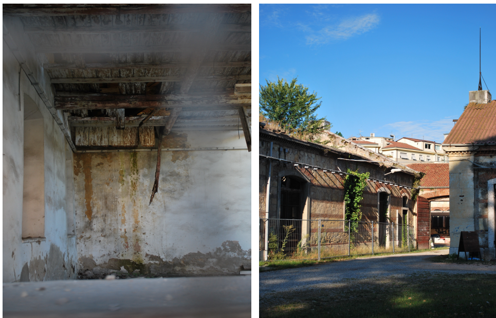
14 e 15 _ vista delle gravi condizioni di degrado su interni ed esterni dei manufatti
