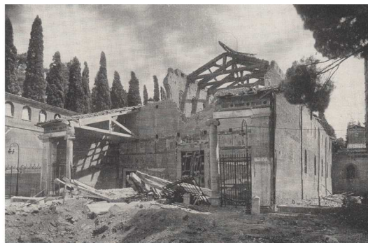
Fig. 4.135. Roma, Basilica di S. Lorenzo fuori le mura, è crollato il portico e un tratto della parete di facciata.
