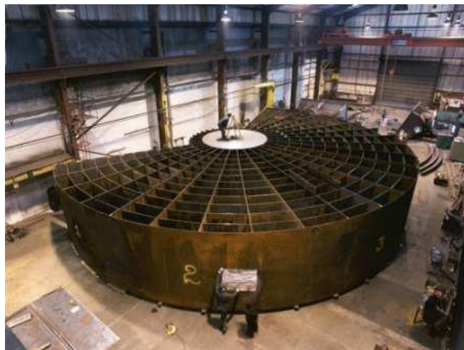
Figura 2.01 – Struttura portante del rotore di uno scambiatore Ljungstrom.
