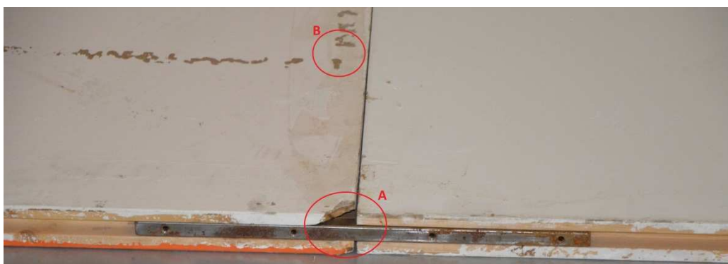
Figura 5-7: Difetti dovuti all'utilizzo. Rottura degli spigoli (A) e deterioramento facciata e verniciatura (B)
