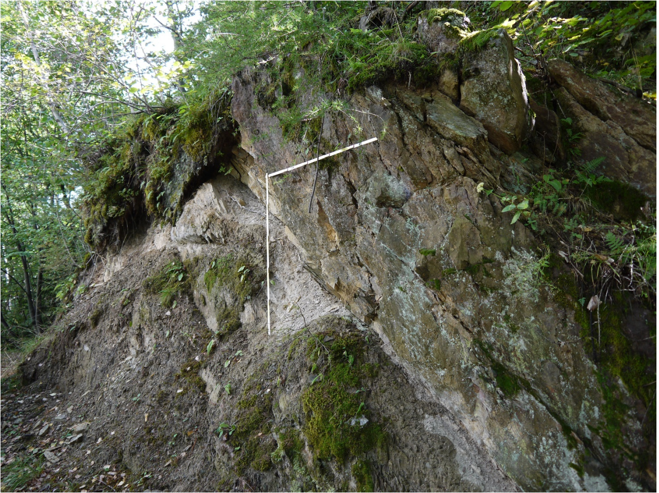
Figura 3-7 – Alterazione delle superfici nell'affioramento n°23.
