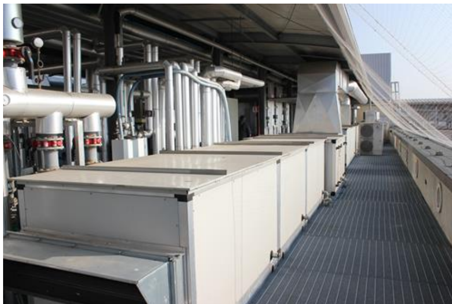
Figura 4.14. UTA rooftop Lotto principale.
