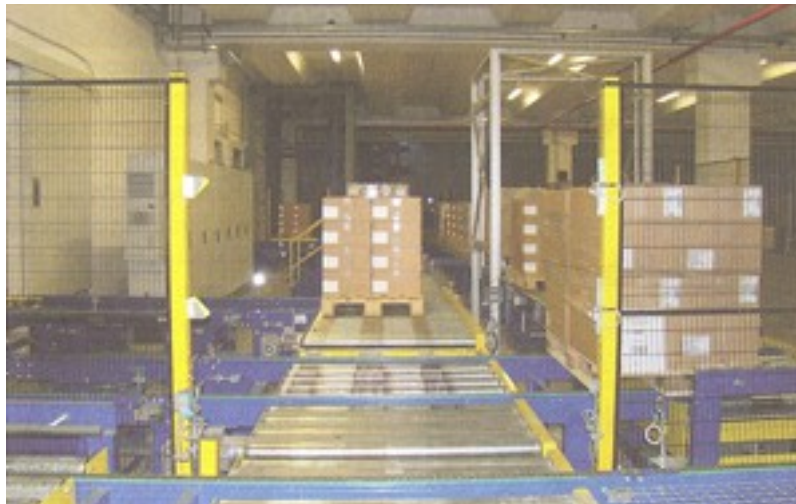
Figura 5.6: Ingresso pallet nella zona ricircolo
