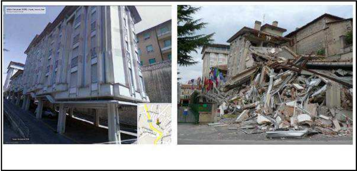
Figura 42 Esempio di piano debole con irregolarità di forma, e struttura - Terremoto dell'Aquila 2009
