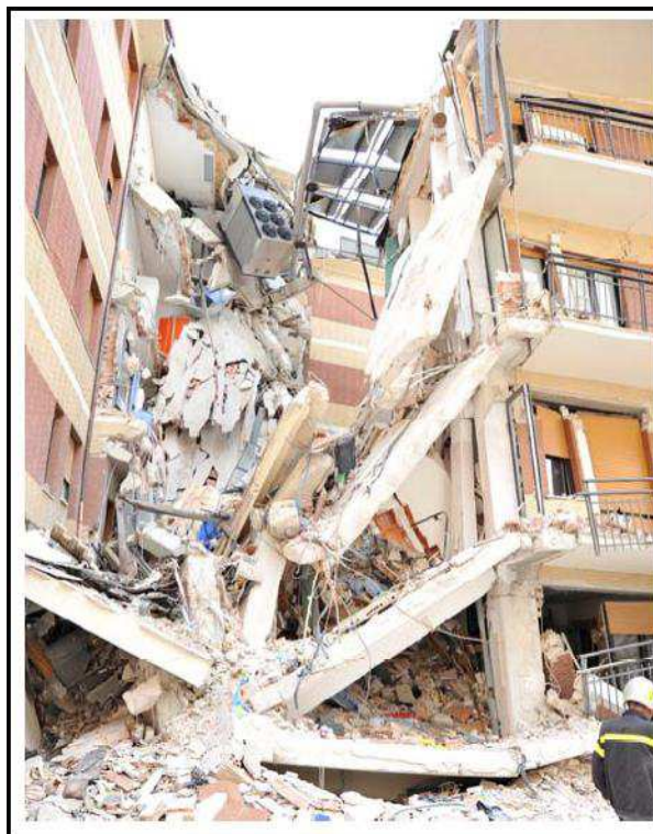
Figura 84 Geometria del collasso dei solai compresi tra le travi 11-25 e 18-29
