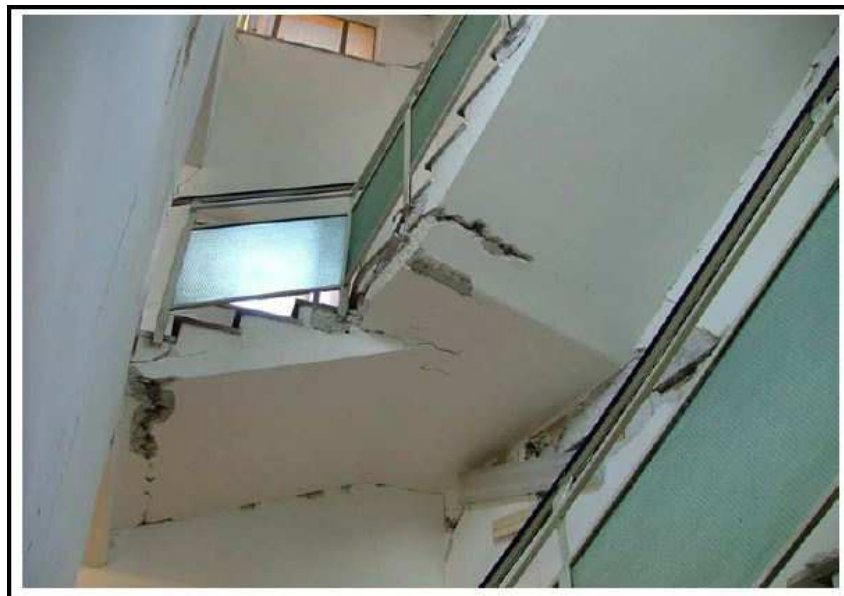
Figura 97 Lesioni agli attacchi con il blocco aule in corrispondenza delle solette rampanti delle travi
