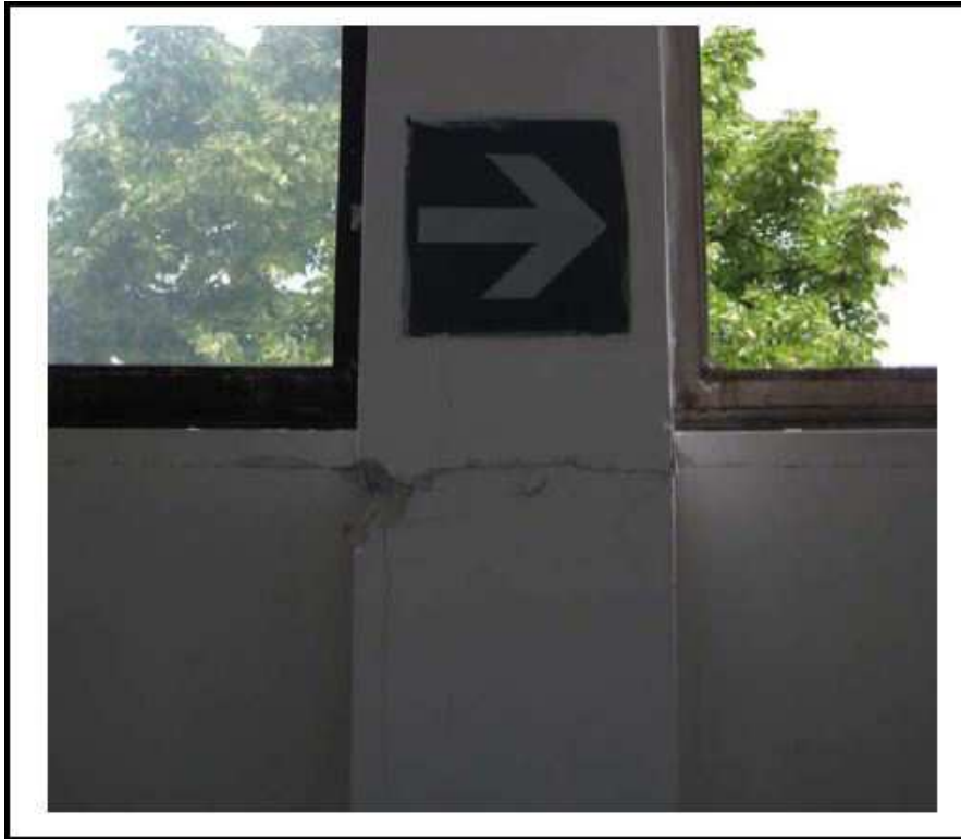
Figura 98 Interazione pilastro-tamponamento rigido sotto finestra
