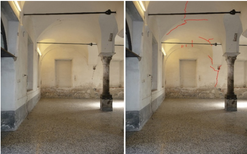
Figura 26_Localizzazione delle propagazioni del quadro fessurativo all'interno del locale ex vestibolo al livello 3
