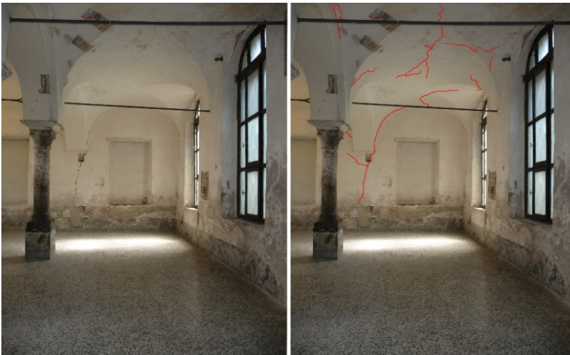
Figura 27_Localizzazione delle propagazioni del quadro fessurativo all'interno del locale ex vestibolo al livello 3
