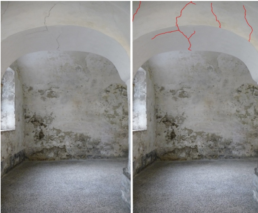
Figura 28_Localizzazione delle propagazioni del quadro fessurativo all'interno del locale ex vestibolo al livello 3
