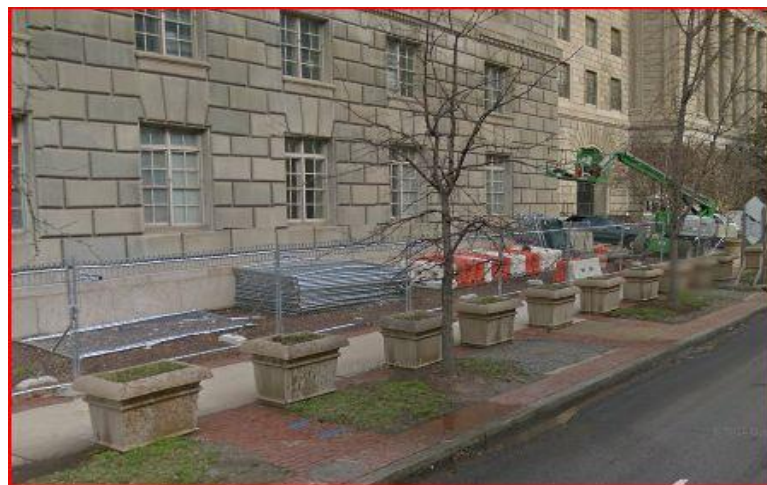
Figura 113. Facciata del dipartimento del commercio che si affaccia sulla 14° strada. Si nota la recinzione del cantiere intorno all'edificio.
