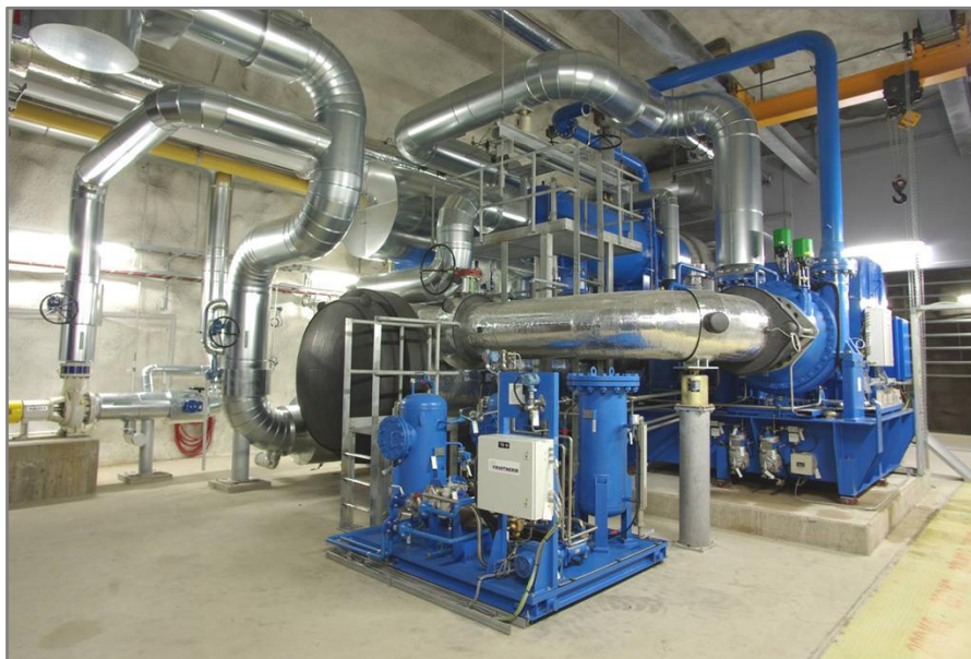
Figura 3.29. Pompa di calore Friotherm Unitop 50 fy con compressore bistadio. (Fonte Friotherm)
