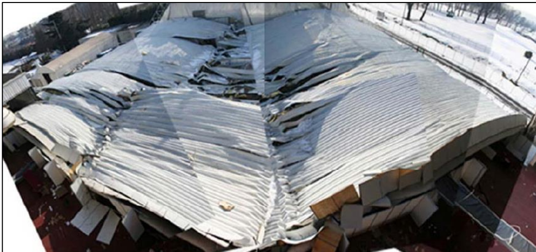
FIGURA 81 L'INSTABILIZZAZIONE È LA PRINCIPALE CAUSA DEL CROLLO DUBITO DOPO IL RIFOLLAMENTO
