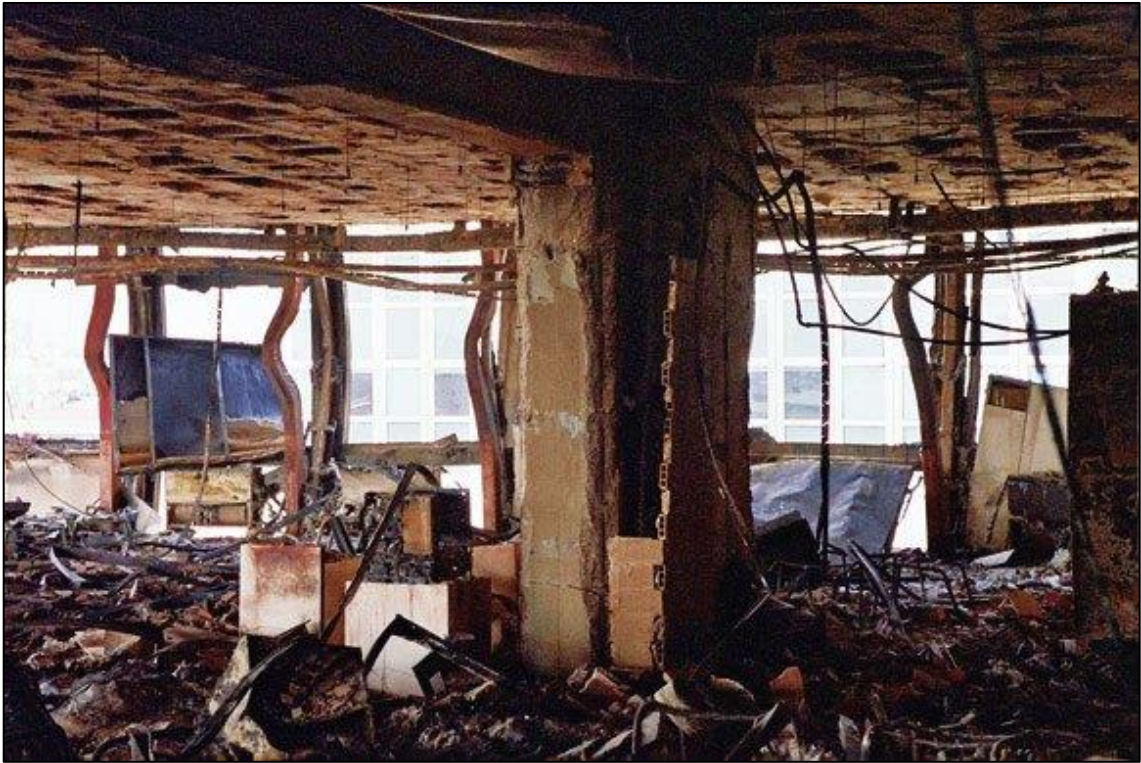
FIGURA 63 UN INTERPIANO DI UNA DELLE 2 TORRI GEMELLE: COLLASSO DEL PILASTRO CENTRALE E BUCKLING DEI PILASTRINI IN ACCIAIO
