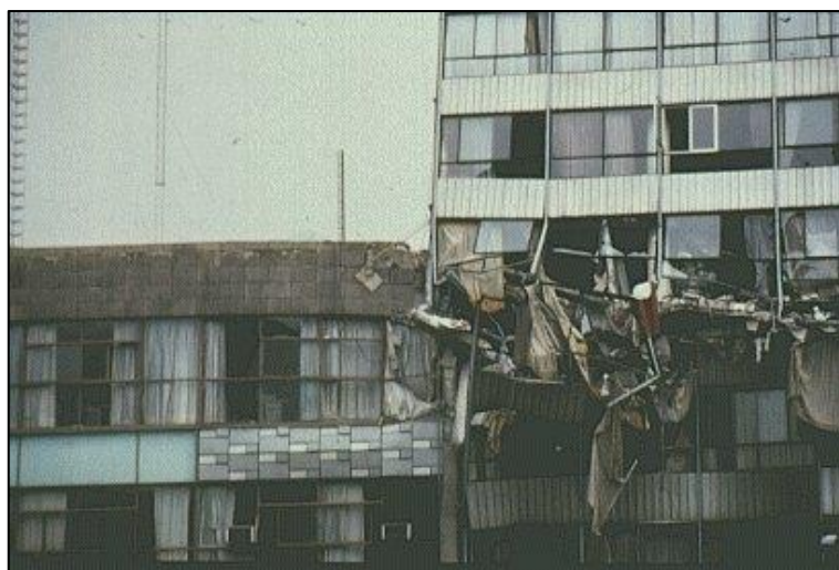
FIGURA 116 BUCKLING DEI PILASTRINI PORTANTI SNELLI IN ACCIAIO IN UN EDIFICIO
