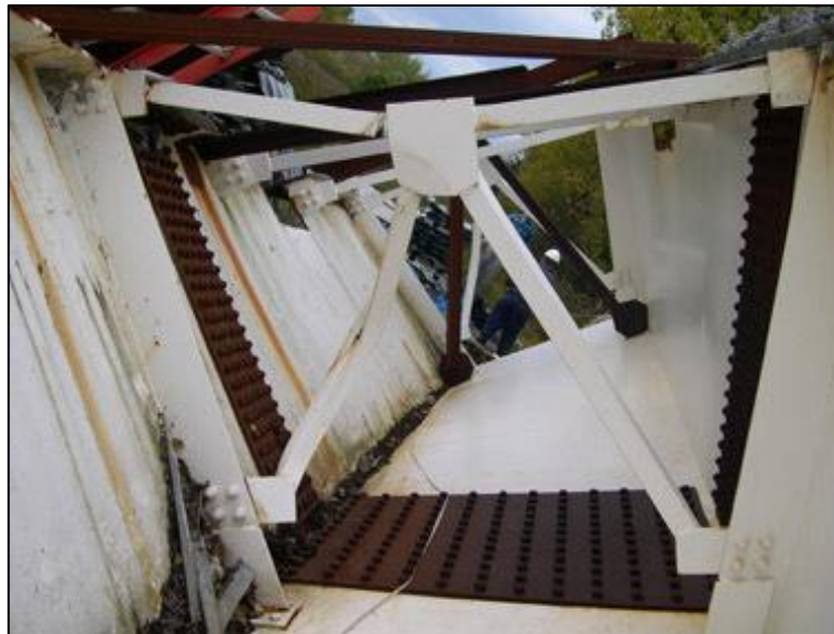
FIGURA 94 PROFILATI PIEGATI IN SEGUITO A INSTABILIZZAZIONE
