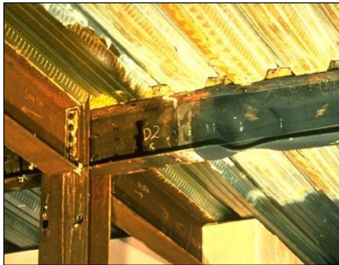
FIGURA 113 BUCKLING LOCALE IN UNA TRAVE IN ACCIAIO
