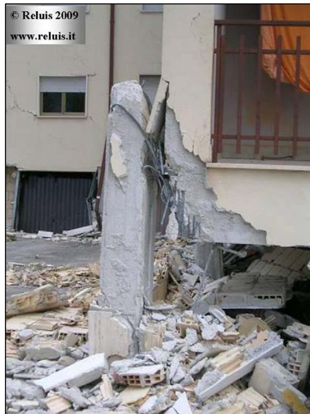
FIGURA 91 PILASTRO TOTALMENTE SENZA STAFFE DOVE IL NODO SI È ADDIRITTURA STACCATO
