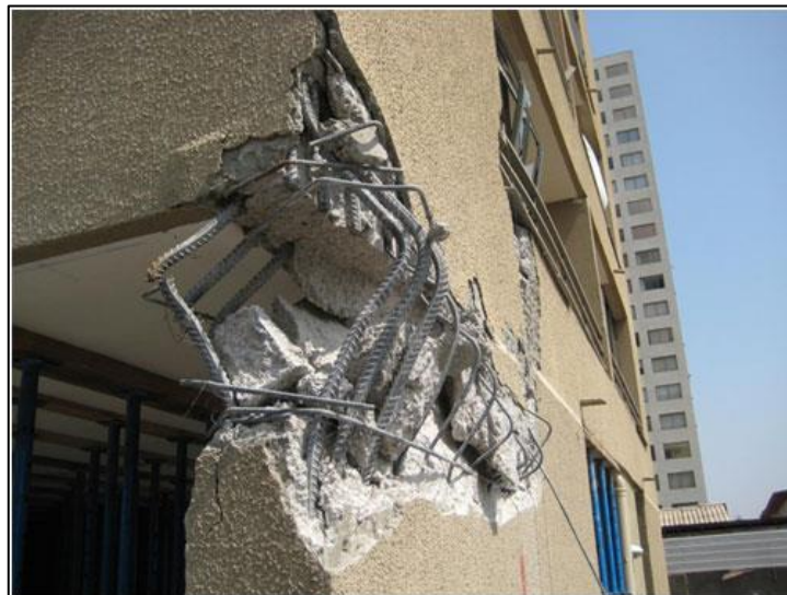
FIGURA 103 BUCKLING DEI TONDINI IN UN PILASTRO ALL'ATTACCO CON LA TRAVE
