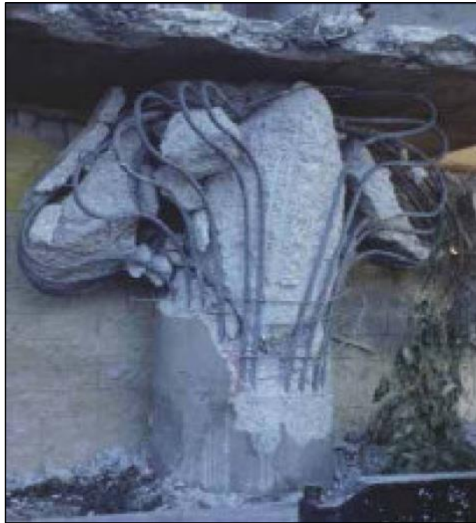
FIGURA 87 PILASTRO CON STAFFE TOTALMENTE ASSENTI
