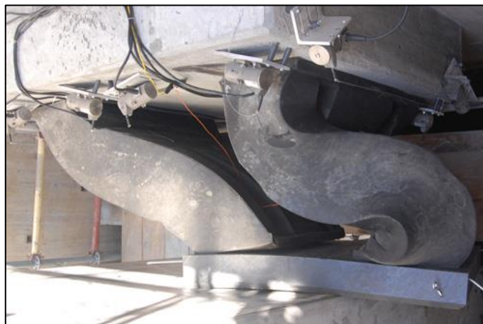
FIGURA 114 BUCKLING CON ESITO ACCENTUATISSIMO IN UNA STRUTTURA DI UNA PIATTAFORMA MARINA
