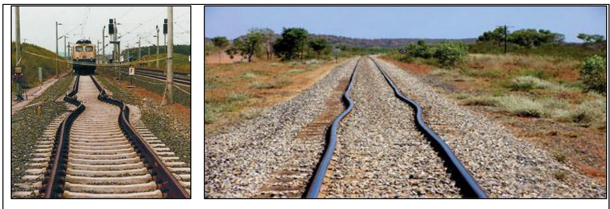
FIGURA 101 THERMAL BUCKLING PER INSUFFICIENZA DI GIOCO NEI GIUNTI
