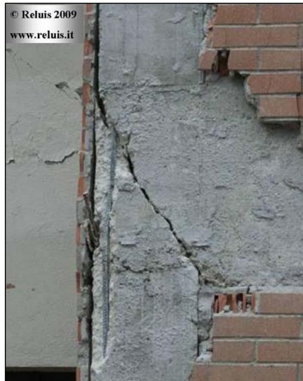
FIGURA 89 NODO SENZA STAFFE CHE PER QUESTO EVIDENZIA LA TIPICA ROTTURA A 45° PER TAGLIO
