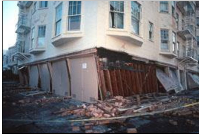
FIGURA 118 BUCKLING DI TUTTI I PILASTRI PORTANTI A PIAN TERRENO IN UN EDIFICIO
