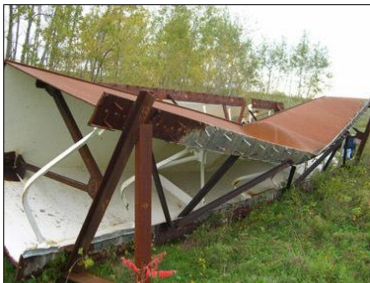
FIGURA 93 PARTICOLARE DEL PONTE PEDONALE CROLLATO AL SUOLO
