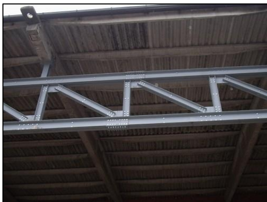
FIGURA 250 TRAVE RETICOLARE IN OPERA: SI VEDONO I PROFILI CHE LA COSTITUISCONO, IMBULLONATI FRA DI LORO
