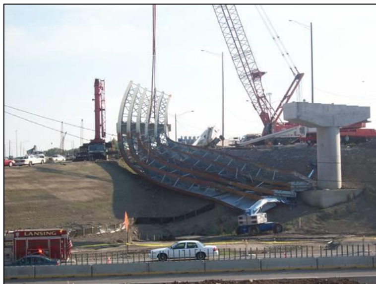
FIGURA 115 CROLLO PER BUCKLING DI PARTI DI UN PONTE DURANTE LA MESSA IN OPERA
