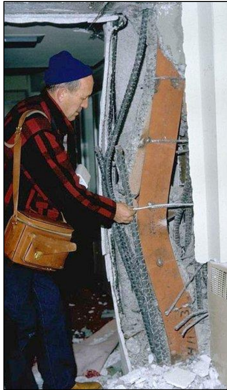
FIGURA 112 BUCKLING DEI FERRI IN UN PILASTRO COMPRESSO
