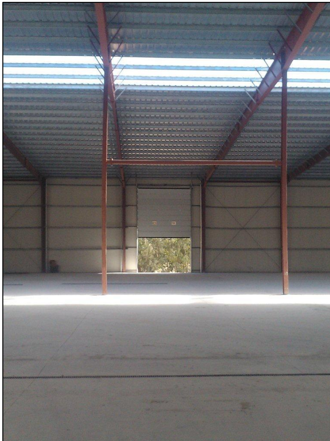
FIGURA 122 BUCKLING IN UN SOSTEGNO AD "H" DELLE TRAVI DI UN CAPANNONE
