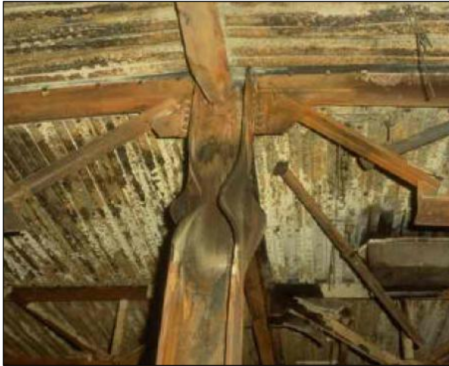
FIGURA 107 BUCKLING LOCALE IN UN PILASTRO IN ACCIAIO
