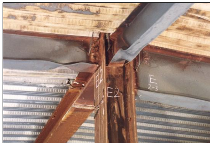
FIGURA 104 BUCKLING LOCALE IN TRAVI PORTANTI
