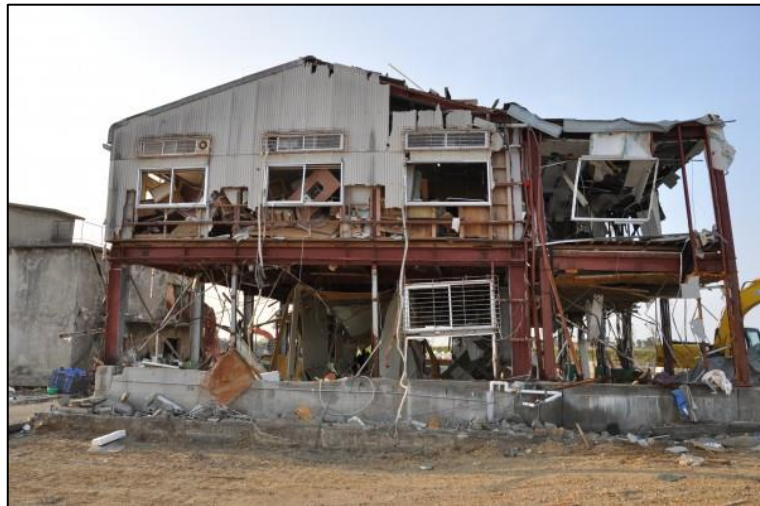
FIGURA 108 BUCKLING DELLE STRUTTURE PORTANTI IN ACCIAIO DI CASA IN GIAPPONE
