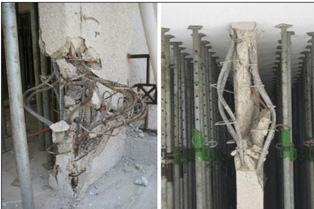
FIGURA 106 BUCKLING DELLE STAFFE IN PILASTRI IN CLS
