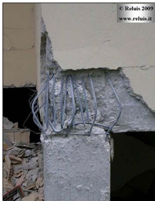
FIGURA 88 ASSENZA DI STAFFE NEL NODO TRAVE-PILASTRO
