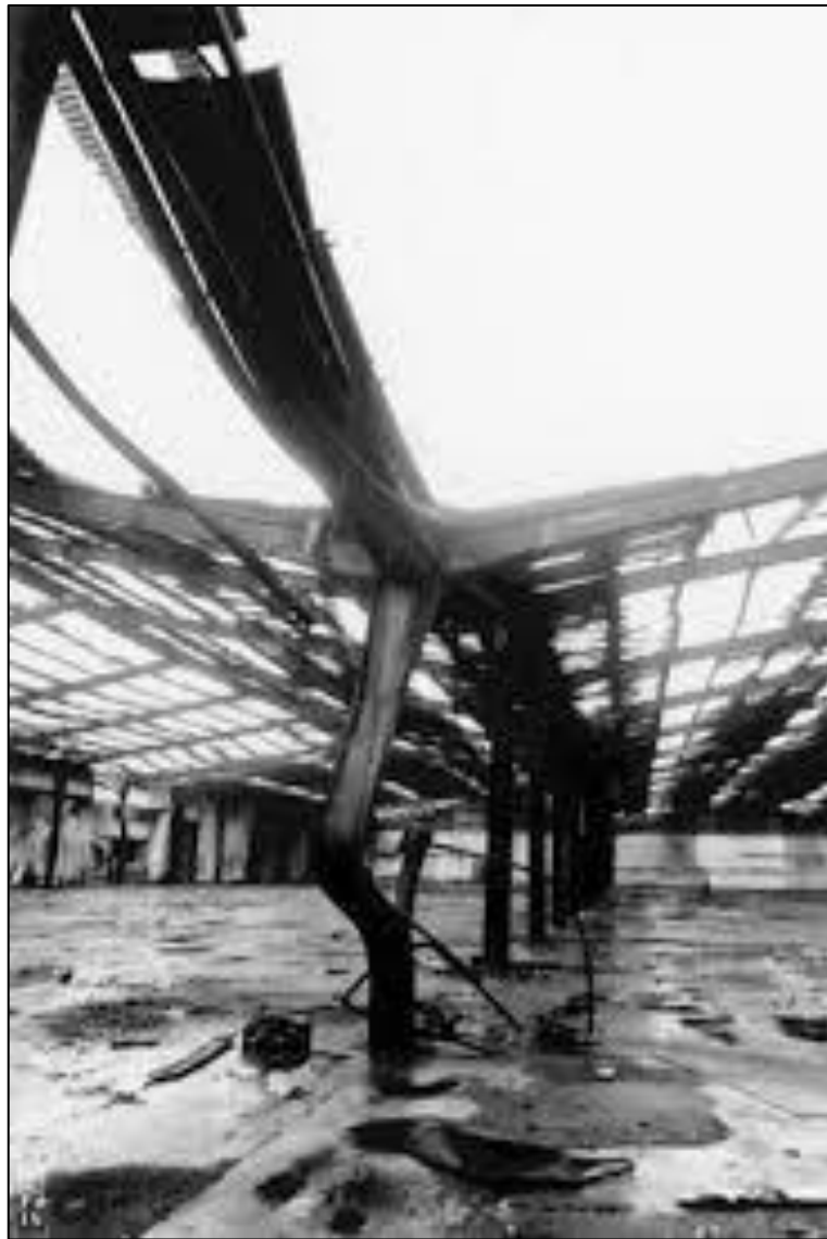
FIGURA 105 BUCKLING DI PILASTRO IN ACCIAIO CHE È IN REALTÀ UN PROFILATO
