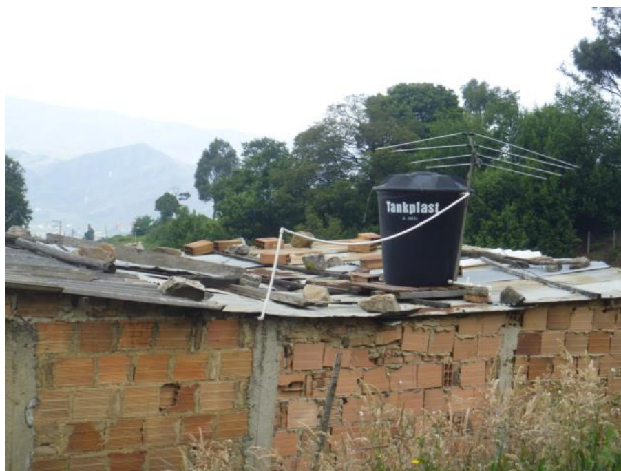
Figura 4.8 : Abitazione con fessure nei muri; impiego di materiali di costruzione scarsi
