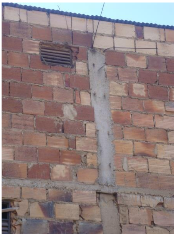
Figura 4.15 : Discontinuità degli elementi strutturali
