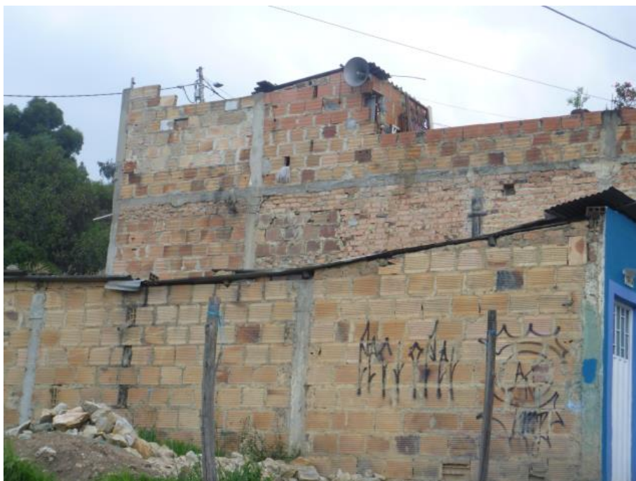
Figura 4.7 : Abitazione con discontinuità degli elementi strutturali
