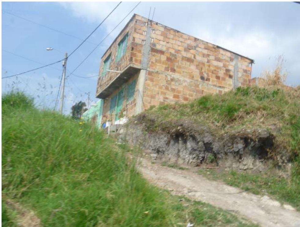
Figura 4.6 : Abitazione con sbalzo senza rinforzo adeguato
