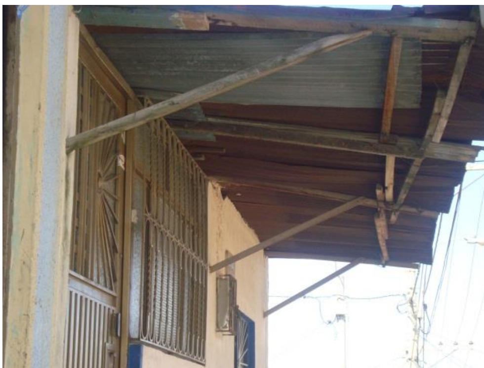
Figura 4.25 : Abitazione con sbalzo non in sicurezza
