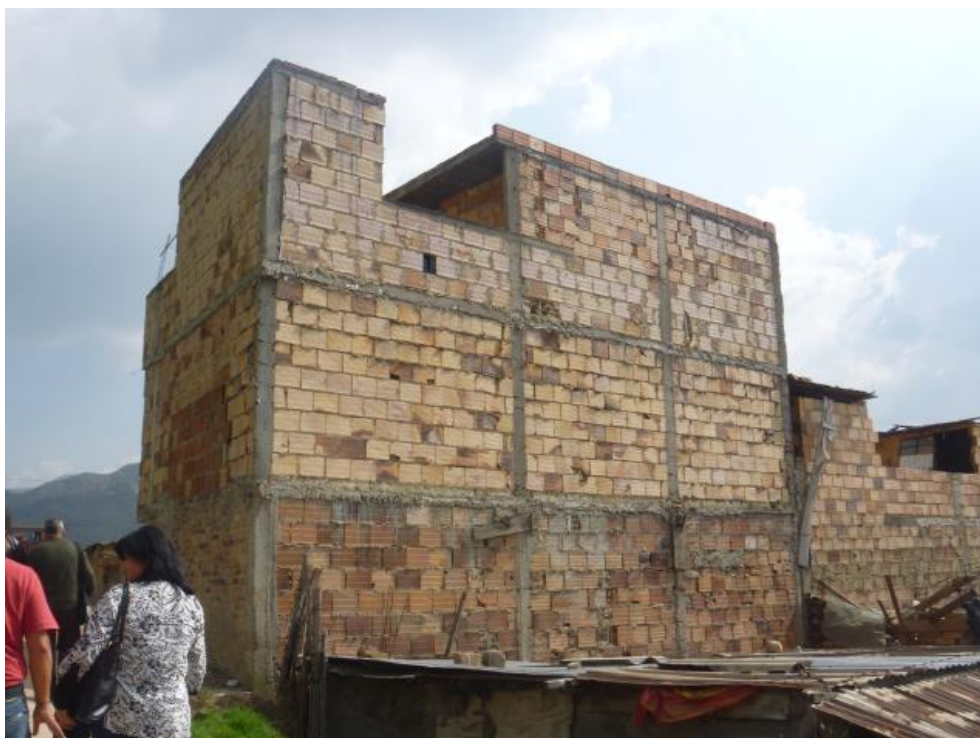
Figura 4.14 : Discontinuità degli elementi
