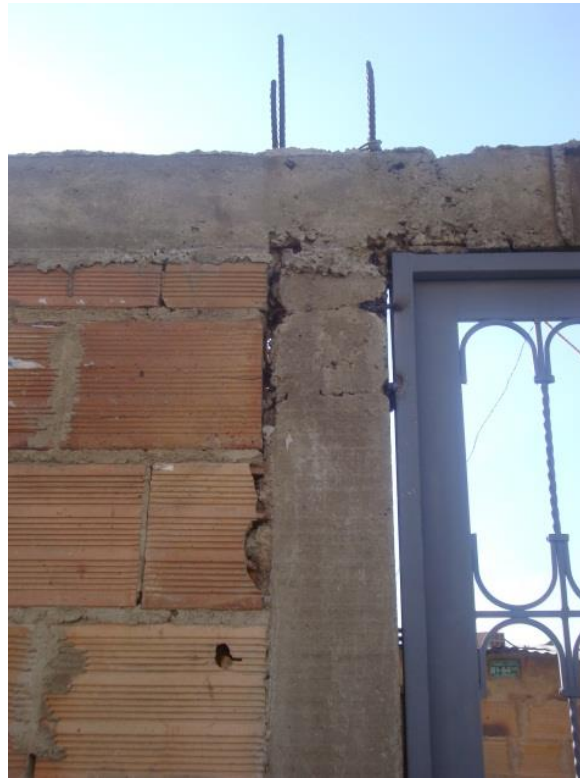
Figura 4.17 : Ferri di richiamo non protetti; muri mal confinati con il calcestruzzo
