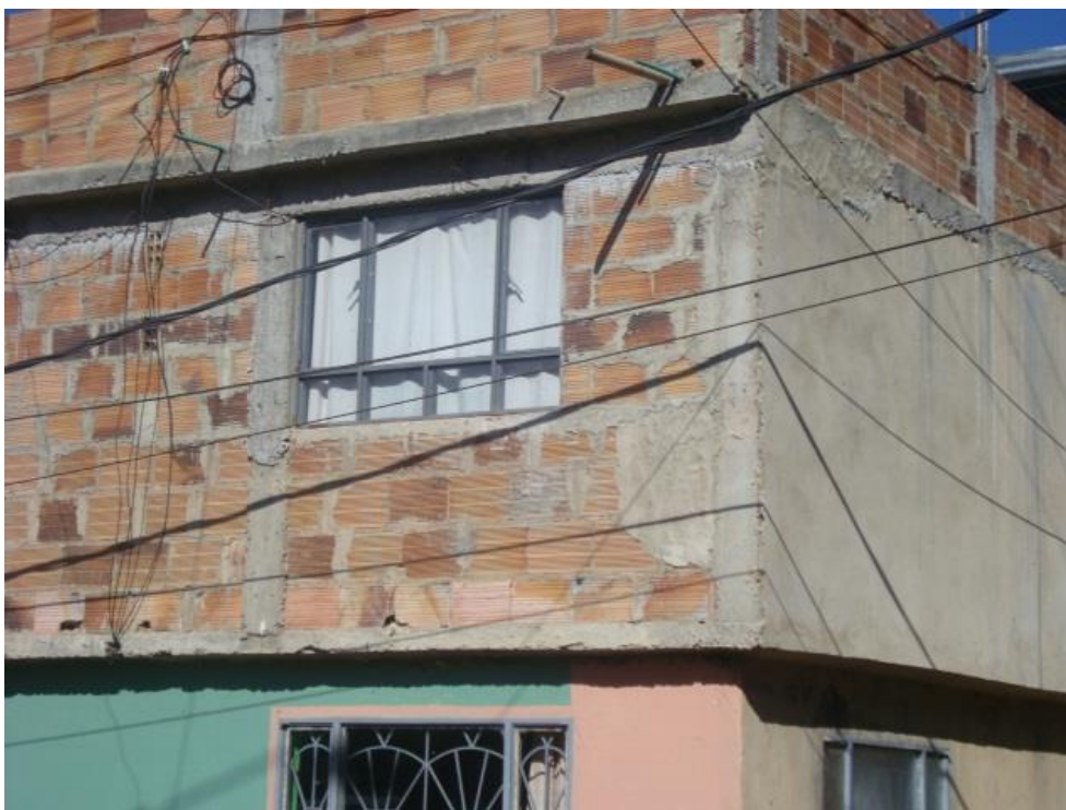
Figura 4.27 : Soletta troppo sottile e pilastri non continui
