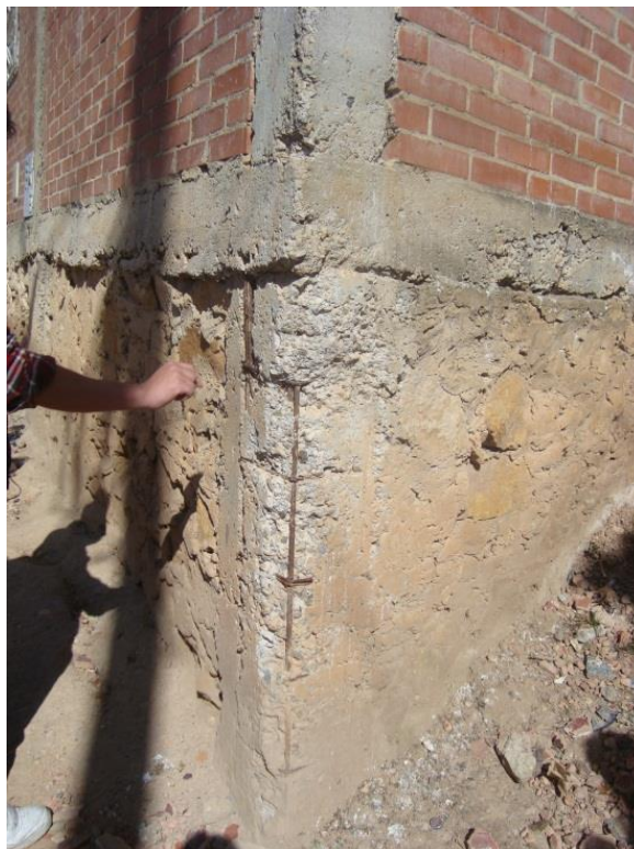
Figura 4.22 : Rinforzo a vista e scarso copriferro
