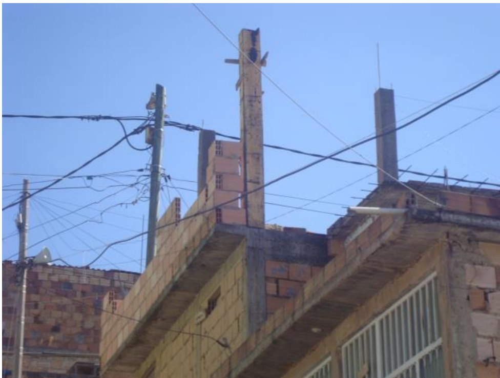
Figura 4.18 : Immagine di una struttura interrotta; ferri esposti
