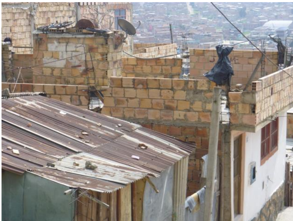
Figura 4.12 : Sopraelevazione piano secondo: sbalzi non corretti e posa errata dei materiali
