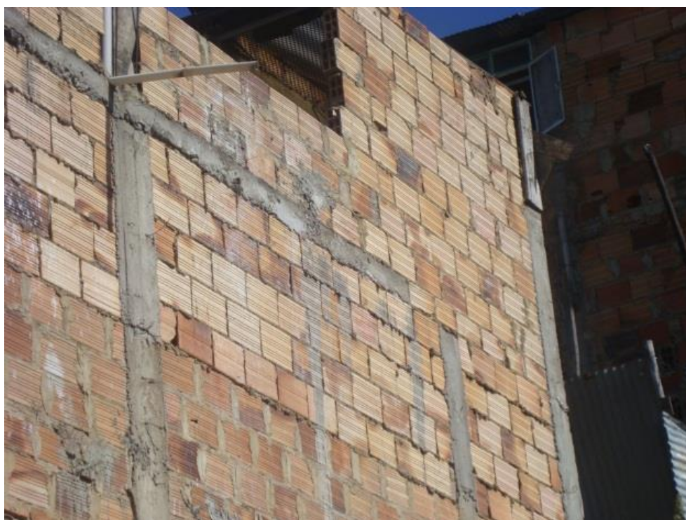
Figura 4.20 : Discontinuità degli elementi strutturali; manodopera scarsa
