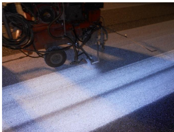
Figura 4.38: Affiancamento delle stese non perfettamente eseguito.
