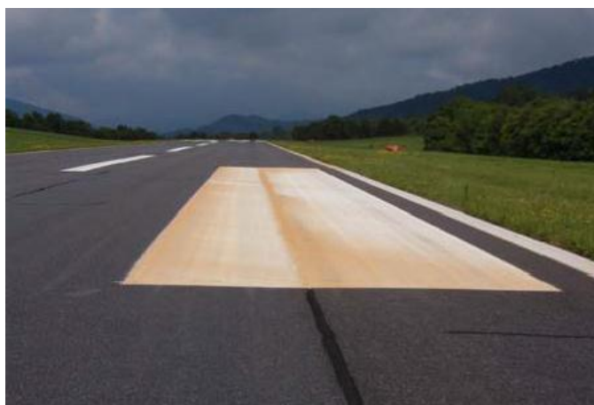
Figura 2.5: Accentuata presenza di ruggine su un marking di pista.
