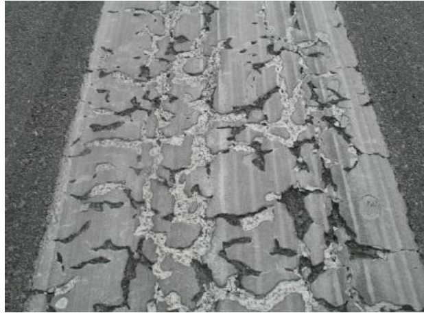
Figura 2.1: Deterioramento provocato dalla sovrapposizione di numerosi strati di pittura.
