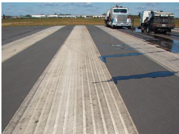
Figura 2.6: Sversamento d'olio sulla pavimentazione e sulla segnaletica orizzontale.
