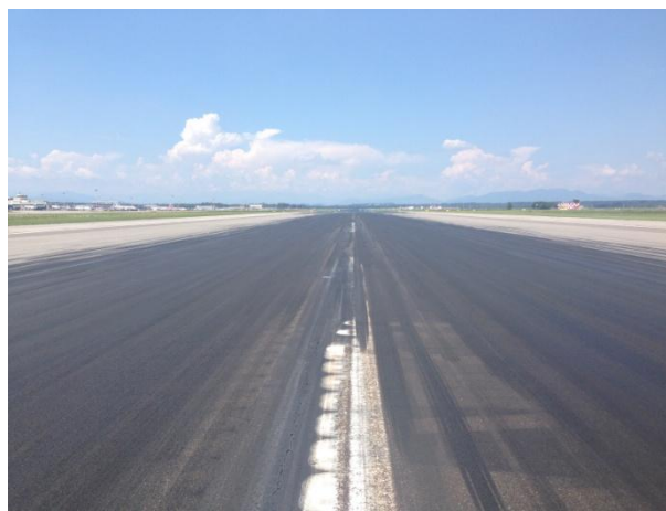
Figura 4.2: Segnaletica quasi completamente oscurata dal deposito di gomma, sulla testata della pista 35L di Malpensa.
