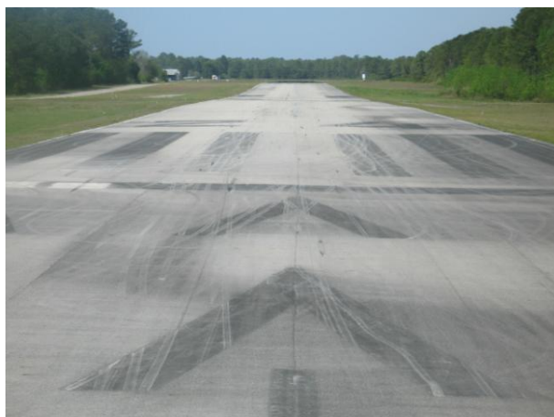
Figura 2.4: Oscuramento della segnaletica orizzontale ad opera di muschi e funghi.
