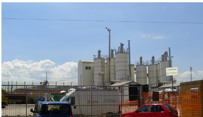
Figura 3.4.4: stazione n°2 di monitoraggio di Igeam nel cantiere di Bologna
