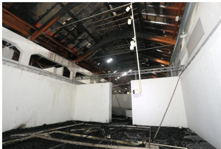
Figura 89: incendio del MAGA: danni provocati alla copertura
