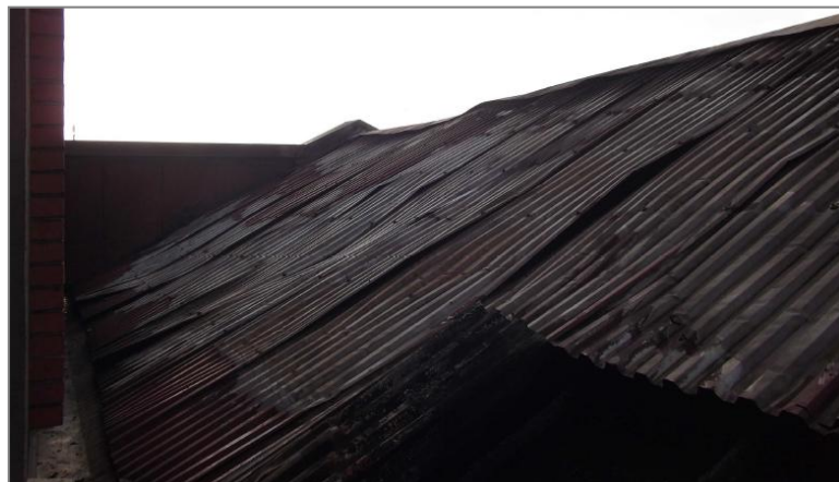
Figura 91: incendio del MAGA: particolare dei danni alla copertura
