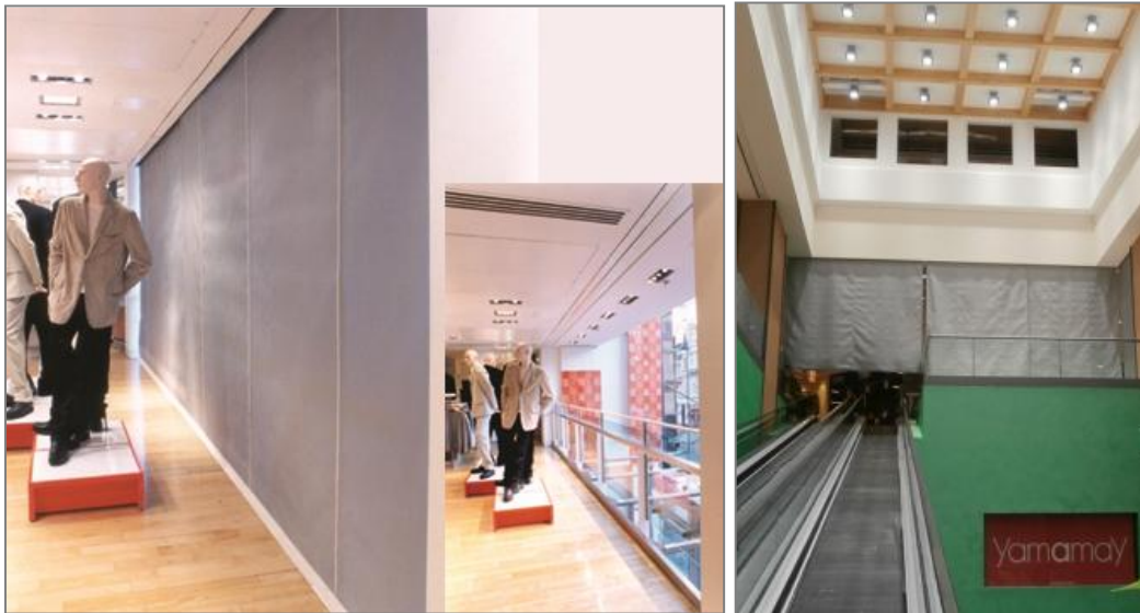
Figura 35: applicazione delle barriere mobili al fumo in un centro commerciale
