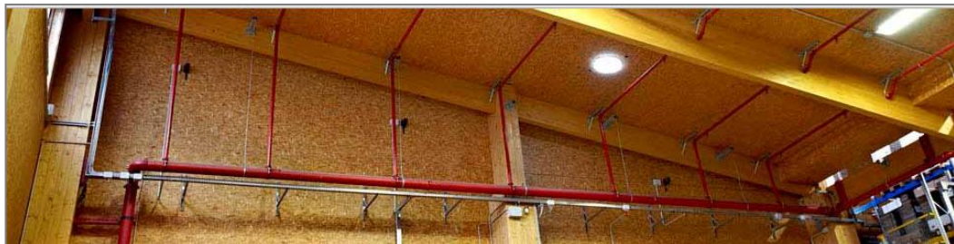
Figura 36: impianto sprinkler di soppressione
