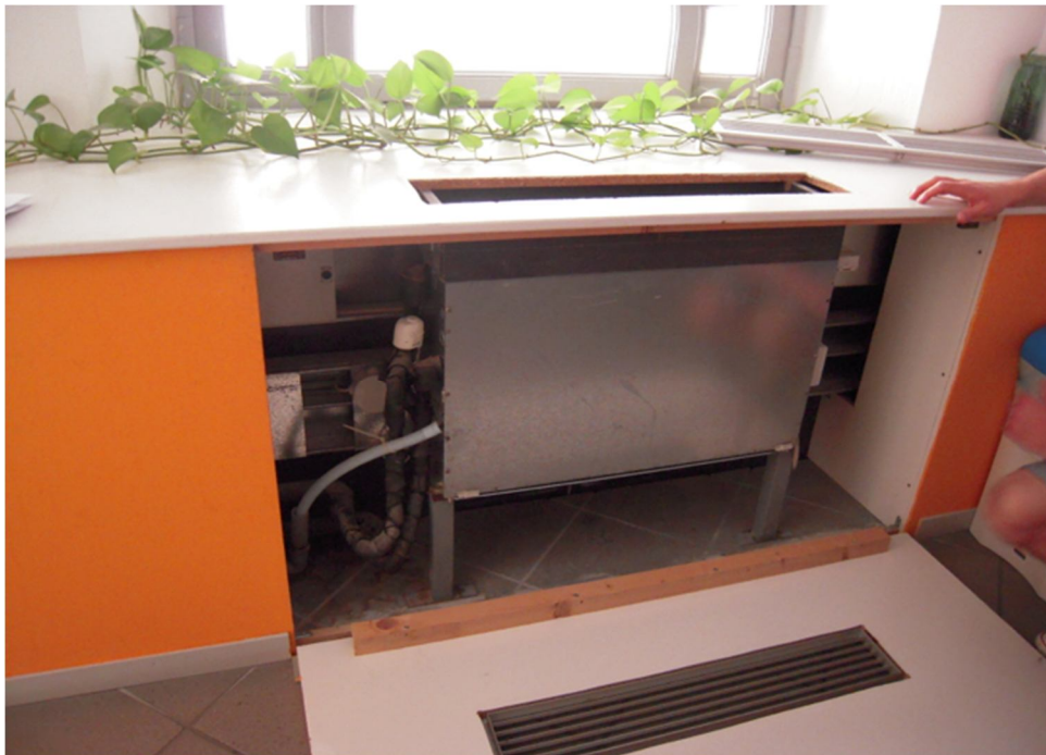
Figura 64 - Foto dell'impianto incassato nella soluzione interessata (Piano Soppalco)
