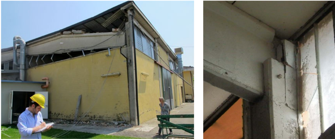
Figura 5: Perdita di appoggio della trave e rottura della forcella in testa al pilastro
