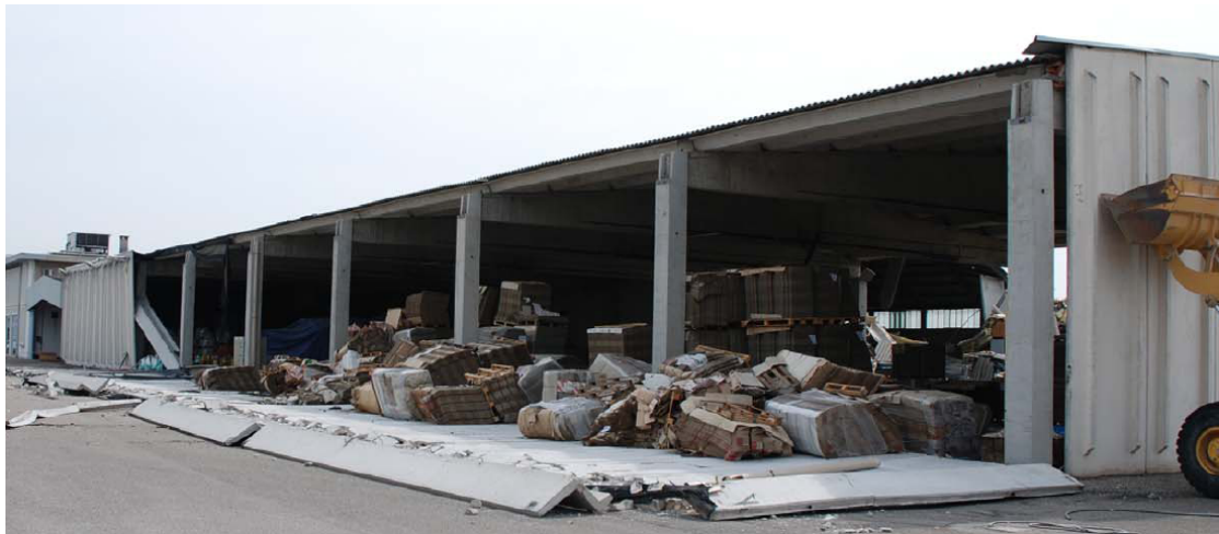
Figura 9: Ribaltamento di pannelli nervati verticali
