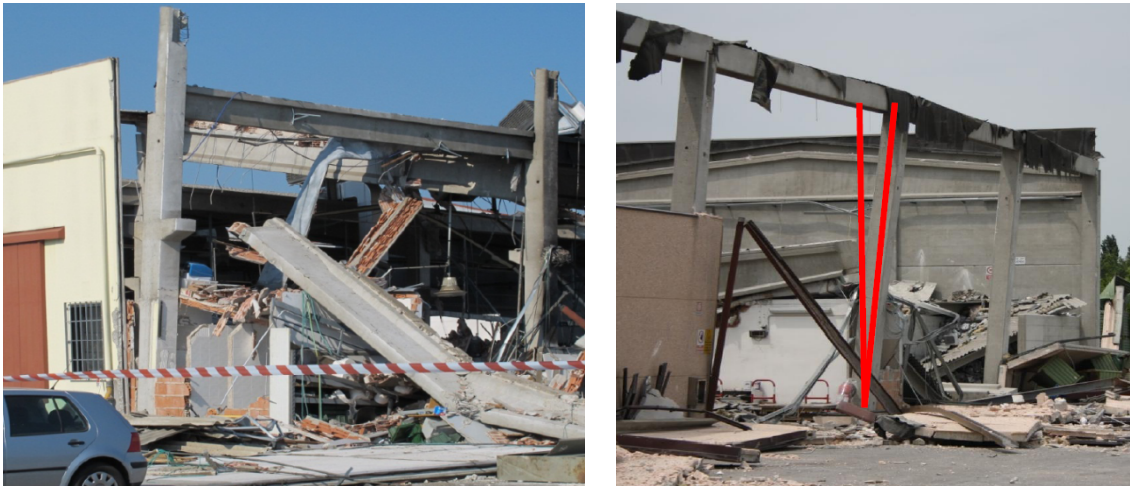
Figura 6: Perdita di verticalità dei pilastri
