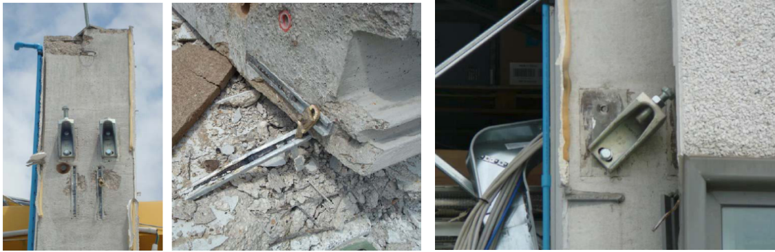
Figura 11: Meccanismi di rottura delle connessioni dei pannelli
