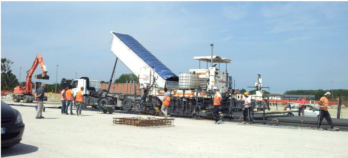
Figura 2.9 Treno di macchine operanti in successione per la stesa di pavimentazioni in calcestruzzo.
