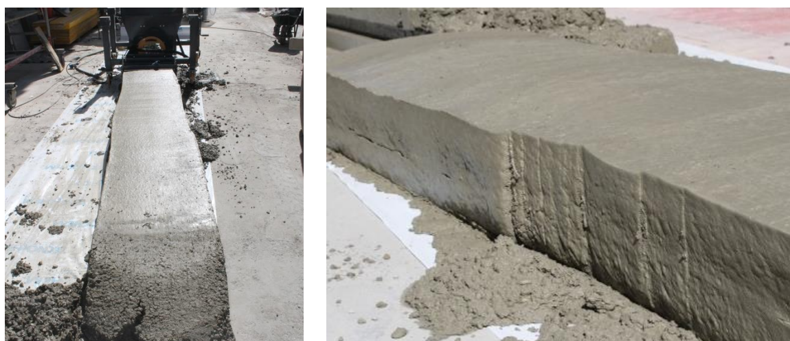
Figura G.3 Difetto di instabilità con finitura ondulata causata da miscela troppo fluida.
