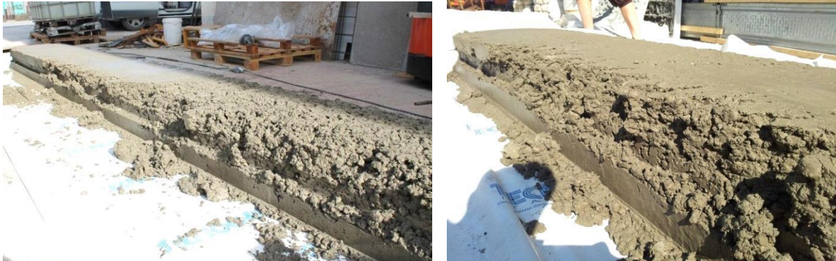
Figura G.8 Difetto di vibrazione intervenuto tra la prima e la seconda parte della lastra (a sinistra) e insufficienza di vibrazione per la finitura del cordolo a quella consistenza del calcestruzzo (a destra).
