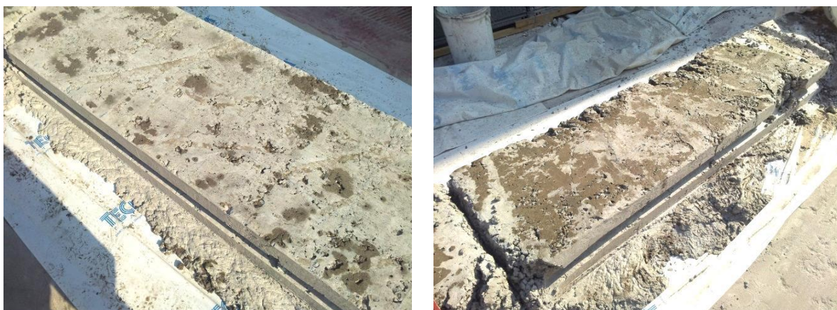
Figura G.7 Finitura superficiale bassa della lastra (a sinistra) e finitura superficiale pessima (a destra).
