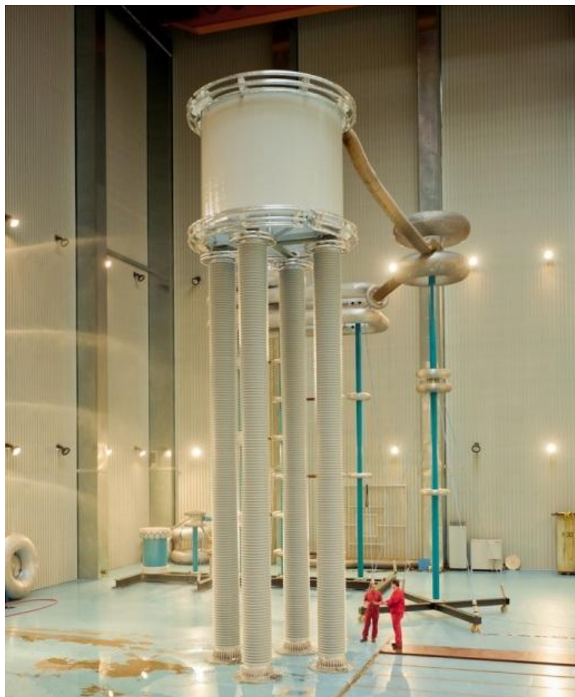
Figura 4 - Reattore di spianamento da 800 kV in fase di test
