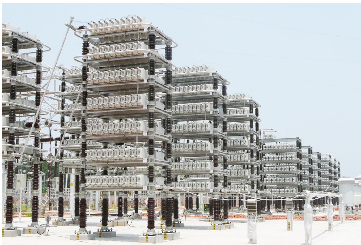
Figura 3 - Rami a valvole di un impianto HVDC
