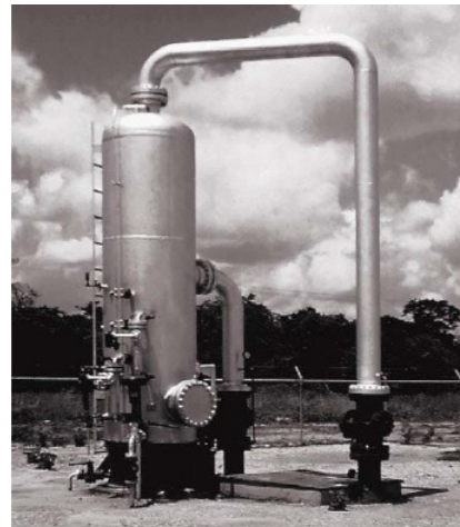
Figura 3.11: Separatore verticale Fonte: Enciclopedia degli idrocarburi
