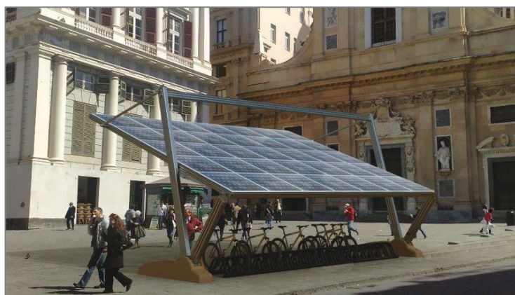
Figura 36: Tettoia fotovoltaica installata nella piazza di un centro storico.
