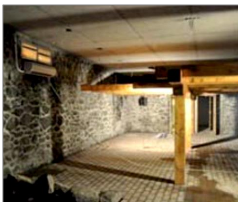
Figura 47: Castello di Kisnàna. Pompa di calore ad aria per il riscaldamento. [Fonte: SECHURBA].
