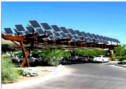
Figura 38: Tettoia fotovoltaica a servizio di un parcheggio.
