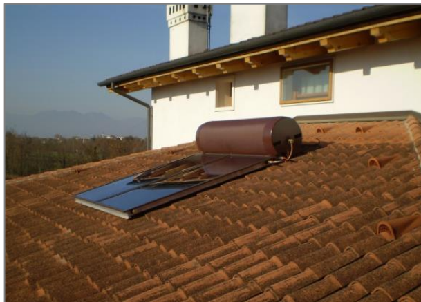
Figura 39: Impianto solare termico a circolazione naturale installato in copertura.
