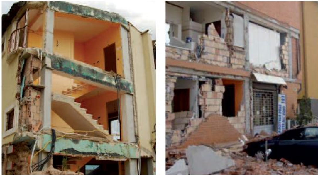
Figura 1-1- Espulsione murature, L'Aquila, 2009
