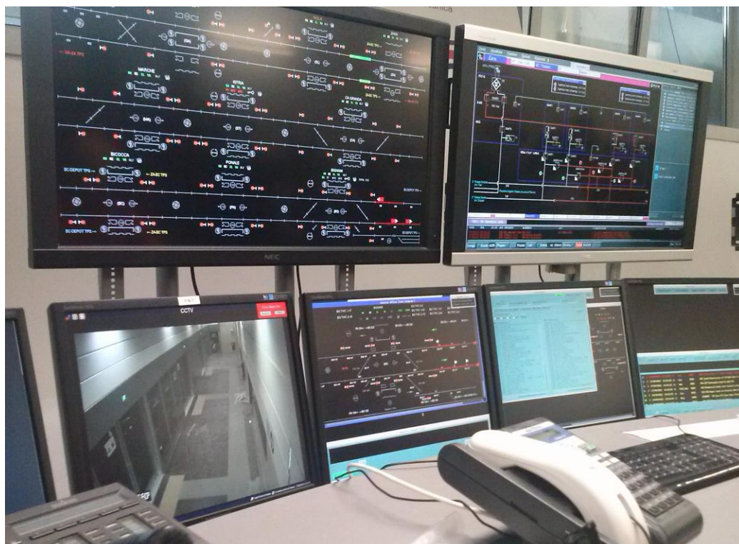
Figura 1.14 Postazione operatore del PCC
