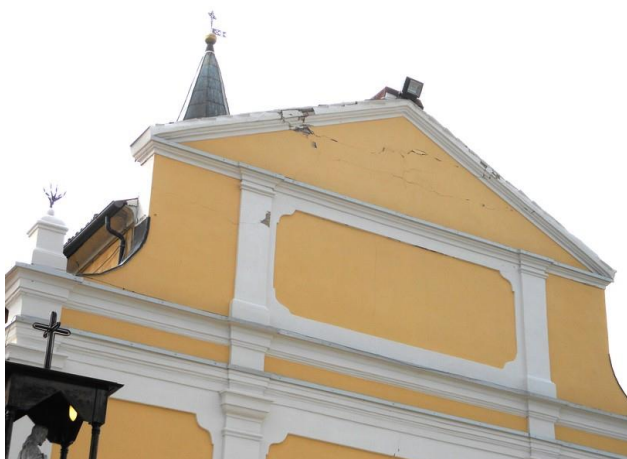
Figura 48 - Chiesa di San Martino Spino dopo il sisma del maggio 2012 - Rif. Bibliog. [10]
