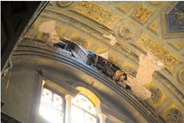
Figura 58 - Interno del duomo di carpi dopo il sisma del 2012 - Rif. Bibliog. [10]
