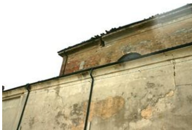
Figura 44 - Lesioni alla muratura della Chiesa di S. Giustina - Rif. Bibliog. [10]
