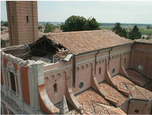
Figura 102 - Chiesa di S. Paolo dopo il sisma del 20 maggio - Rif. Bibliog. [34]
