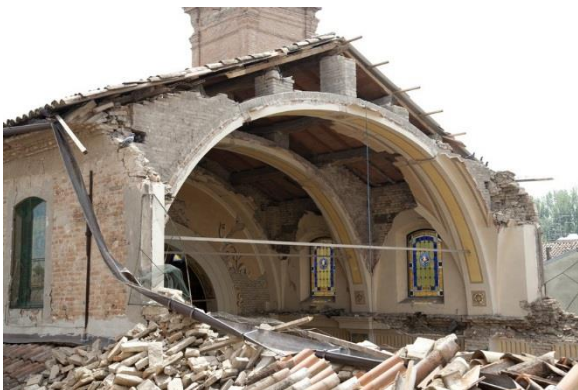
Figura 15 - Duomo della Conversione di S. Paolo dopo il sisma del 29 maggio 2012 - Rif. Bibliog. [10]
