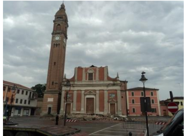
Figura 99 - Facciata della Chiesa di S. Paolo dopo il sisma del 20 maggio - Rif. Bibliog. [34]
