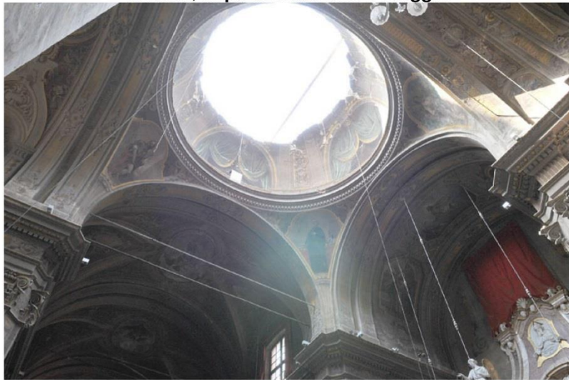
Interno, dopo il sisma del 29 Maggio
