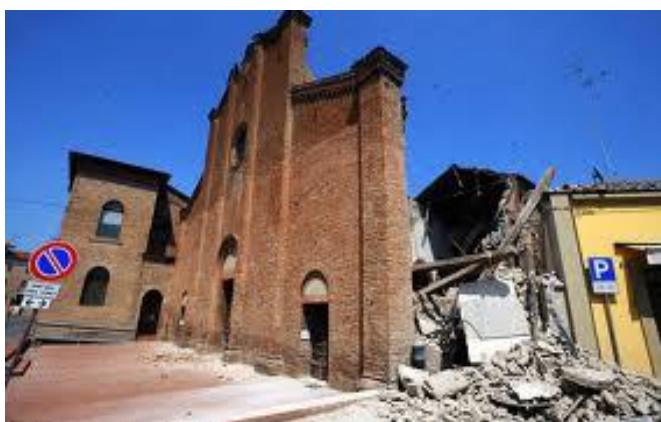
Figura 26 - Chiesa di S. Francesco dopo il sisma del 29 maggio 2012 - Rif. Bibliog. [22]
