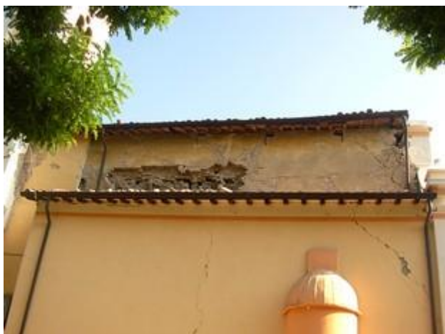
Figura 46 - Lesioni alla muratura della Chiesa di S. Martino Carano - Rif. Bibliog. [10]
