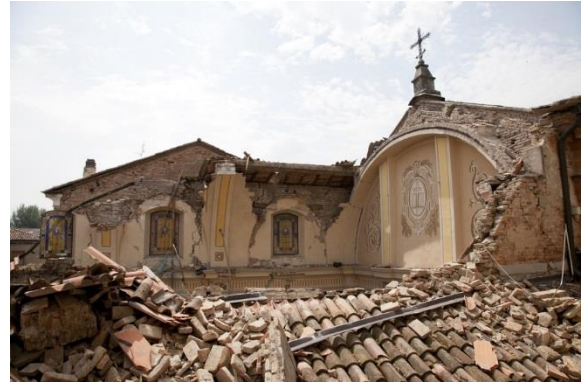
Figura 14 - Duomo della Conversione di S. Paolo dopo il sisma del 29 maggio 2012 - Rif. Bibliog. [10]
