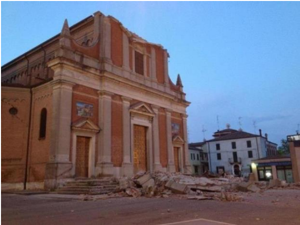
Figura 98 - Facciata della Chiesa di S. Paolo dopo il sisma del 20 maggio - Rif. Bibliog. [33]
