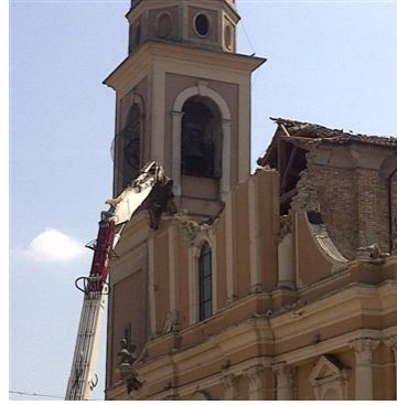
Figura 120 - facciata della Chiesa di S. Maria Maggiore dopo il sisma del maggio 2012 - Rif. Bibliog. [14]
