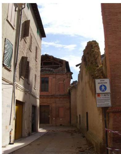
Figura 28 - Oratorio del Santissimo Sacramento dopo il terremoto del 2012 - Rif. Bibliog. [23]
