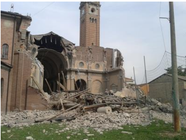
Figura 100 - Abside della Chiesa di S. Paolo dopo il sisma del 2012 - Rif. Bibliog. [35]
