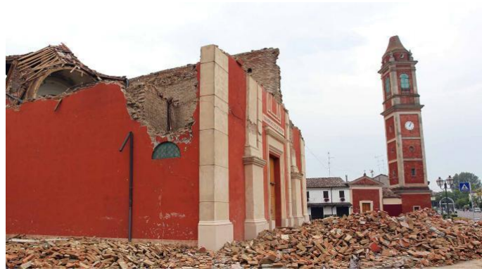
Figura 106 - Chiesa di S. Martino di Tour dopo il sisma del 2012 - Rif. Bibliog. 28
