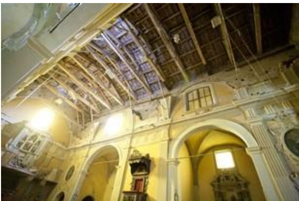
Figura 4 - interno della chiesa di s. Pietro Apostolo dopo il sisma del 20 maggio 2012 - Rif. Bibliog. [10]
