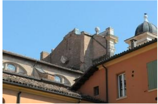
Figura 59 - Particolare del danneggiamento della facciata del Duomo di Carpi dopo il sisma del maggio 2012 - Rif. Bibliog. [10]
