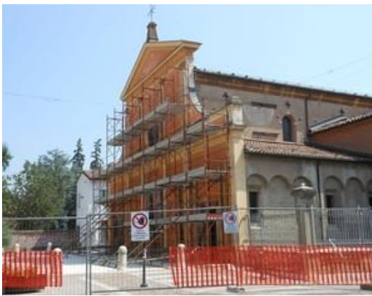
Figura 95 - Chiesa di S. Zenone durante i lavori di messa in sicurezza della facciata - Rif. Bibliog. [31]
