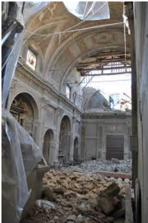
Figura 86 - Interno della Chiesa di S. Egidio dopo il sisma del maggio 2012 - Rif. Bibliog. [29]
