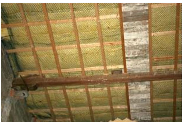
Figura 43 - Soffitto della Chiesa di S. Giustina - Rif. Bibliog. [10]
