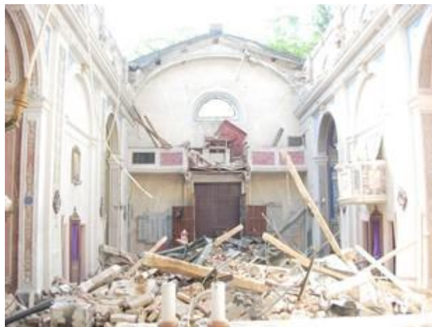
Figura 63 - Interno della Chiesa di San Martino dopo il sisma del 20 maggio 2012 - Rif. Bibliog. [10]
