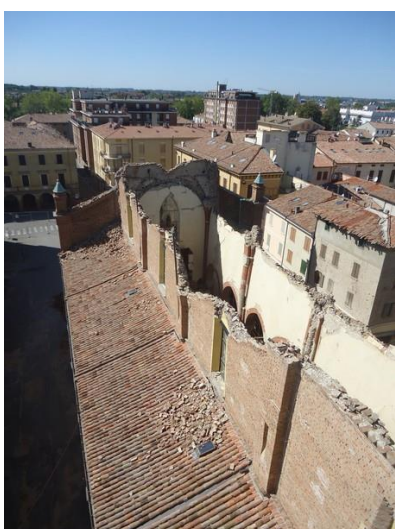
Figura 22 - Duomo di Mirandola dopo il sisma del 2012 - Rif. Bibliog. [18]
