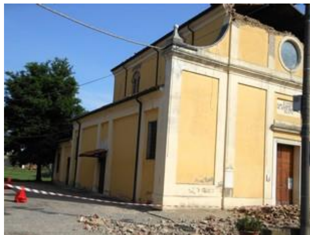
Figura 50 - Chiesa della Visitazione della Beata Vergine Maria dopo il sisma del 2012 - Rif. Bibliog. [10]
