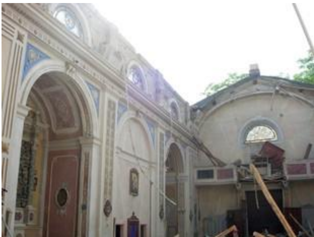
Figura 62 - Interno della Chiesa di San Martino Secchia dopo il sisma del 20 maggio 2012 - Rif. Bibliog. [10]
