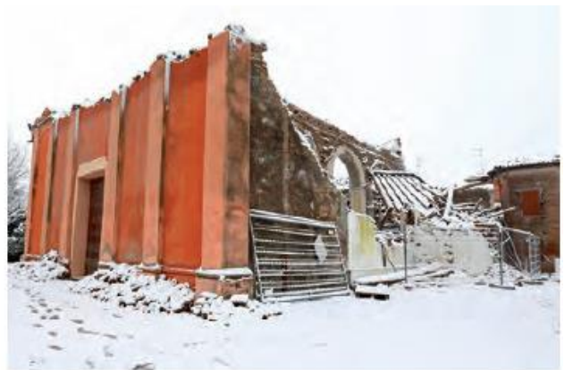
Figura 89 - Chiesa di S. Bartolomeo dopo il sisma - Rif. Bibliog. [31]
