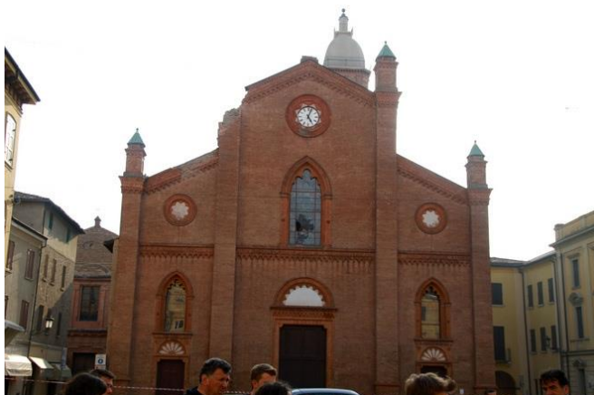
Figura 23 - Duomo di Mirandola dopo il sisma del 20 maggio 2012 - Rif. Bibliog. [19]
