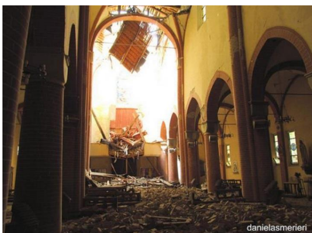
Figura 21 - Interno del Duomo di Mirandola dopo il sisma del maggio 2012 - Rif. Bibliog. [17]
