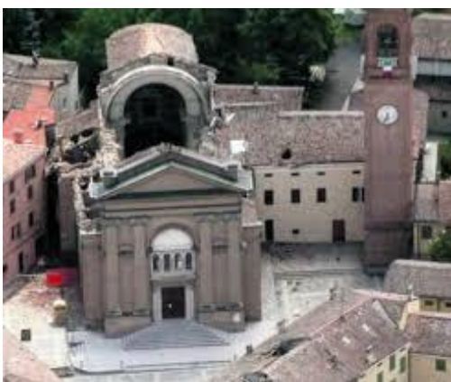
Figura 84 - Chiesa di S. Egidio dopo il sisma del maggio 2012 - Rif. Bibliog. [29]
