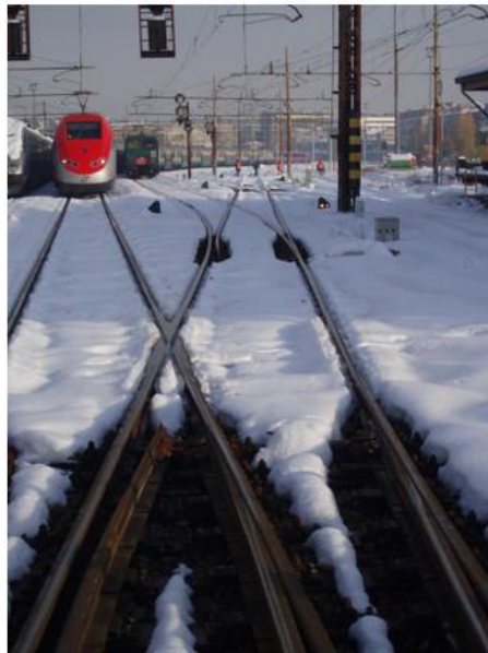
Figura 8-10 Scambio ferroviario nel quale è stato attivato il sistema di snevamento
