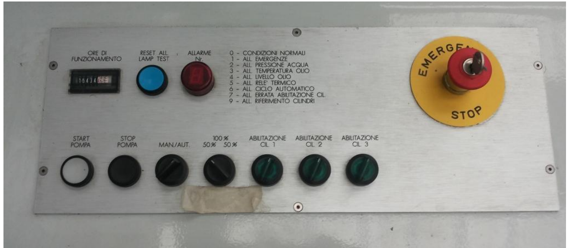
Figura 3.2 Quadro di comando
