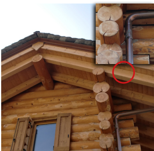
abbassamento della costruzione
