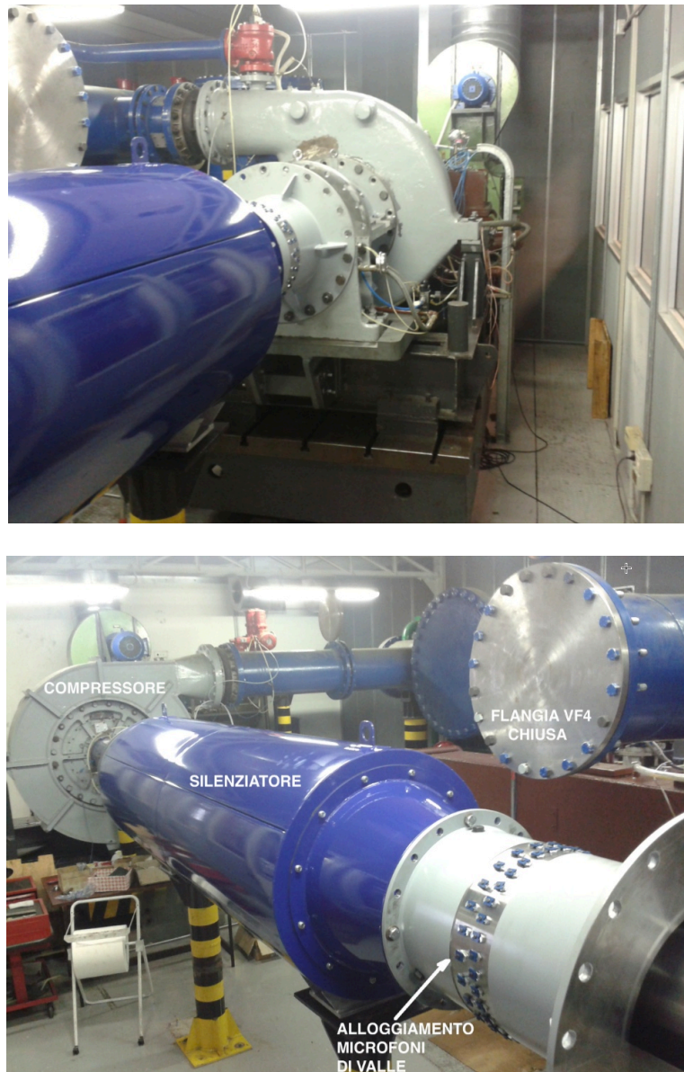
Figura 3.7: Vista del silenziatore tra turbina e compressore
