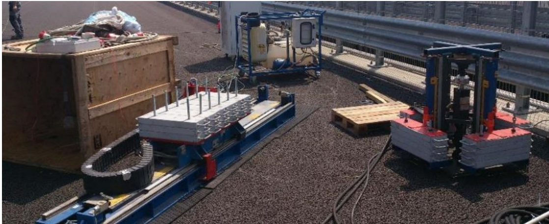
Figura 5.11: motore elettromagnetico lineare (a sinistra) e pistone oleodinamico (a destra) posizionati sul ponte Muzza.
