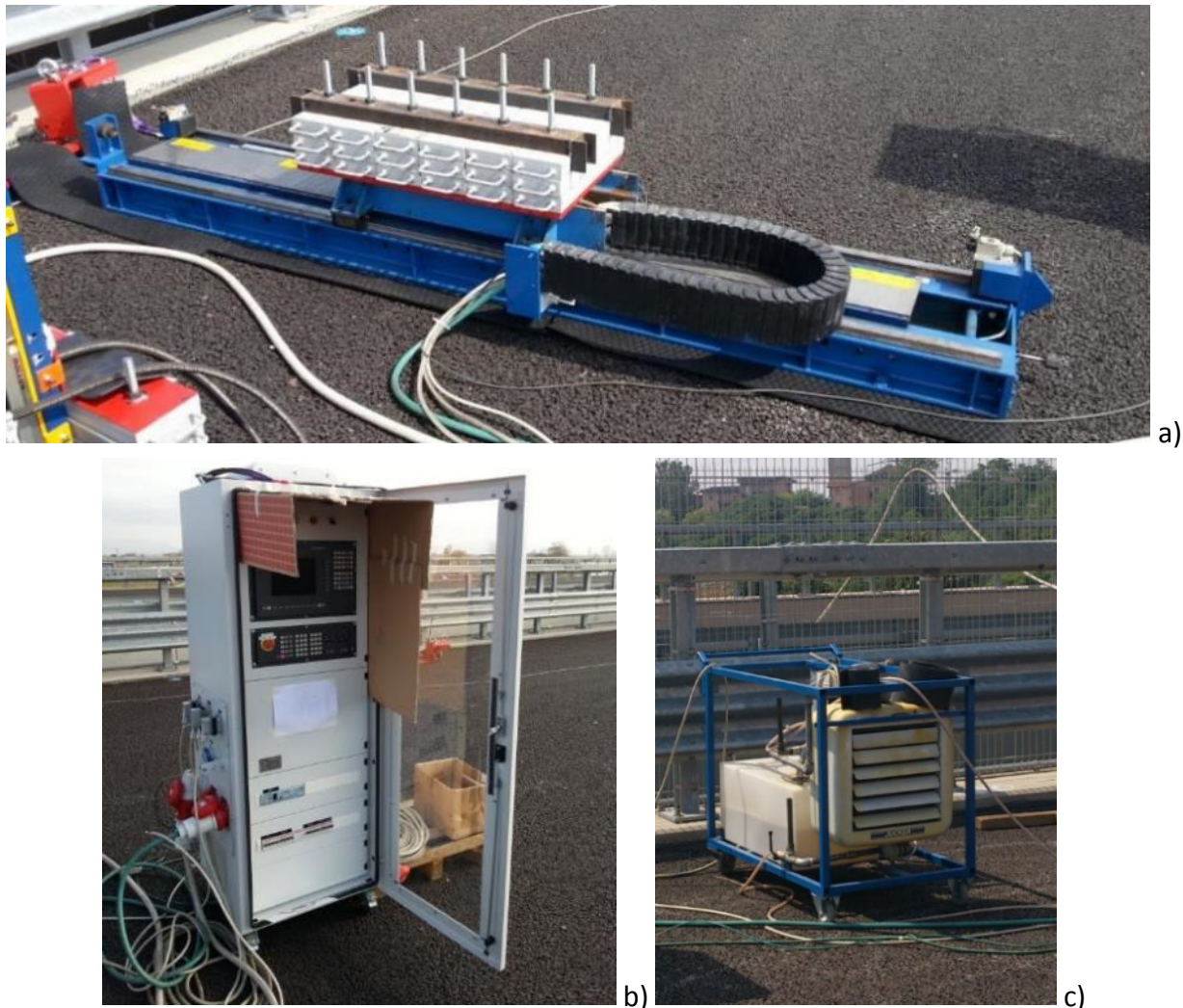
Figura 2.9: componenti del sistema di forzamento orizzontale; a) motore elettromagnetico lineare posizionato sul ponte Muzza carreggiata Nord; b) sistema di controllo e alimentazione; c) sistema di raffreddamento.
