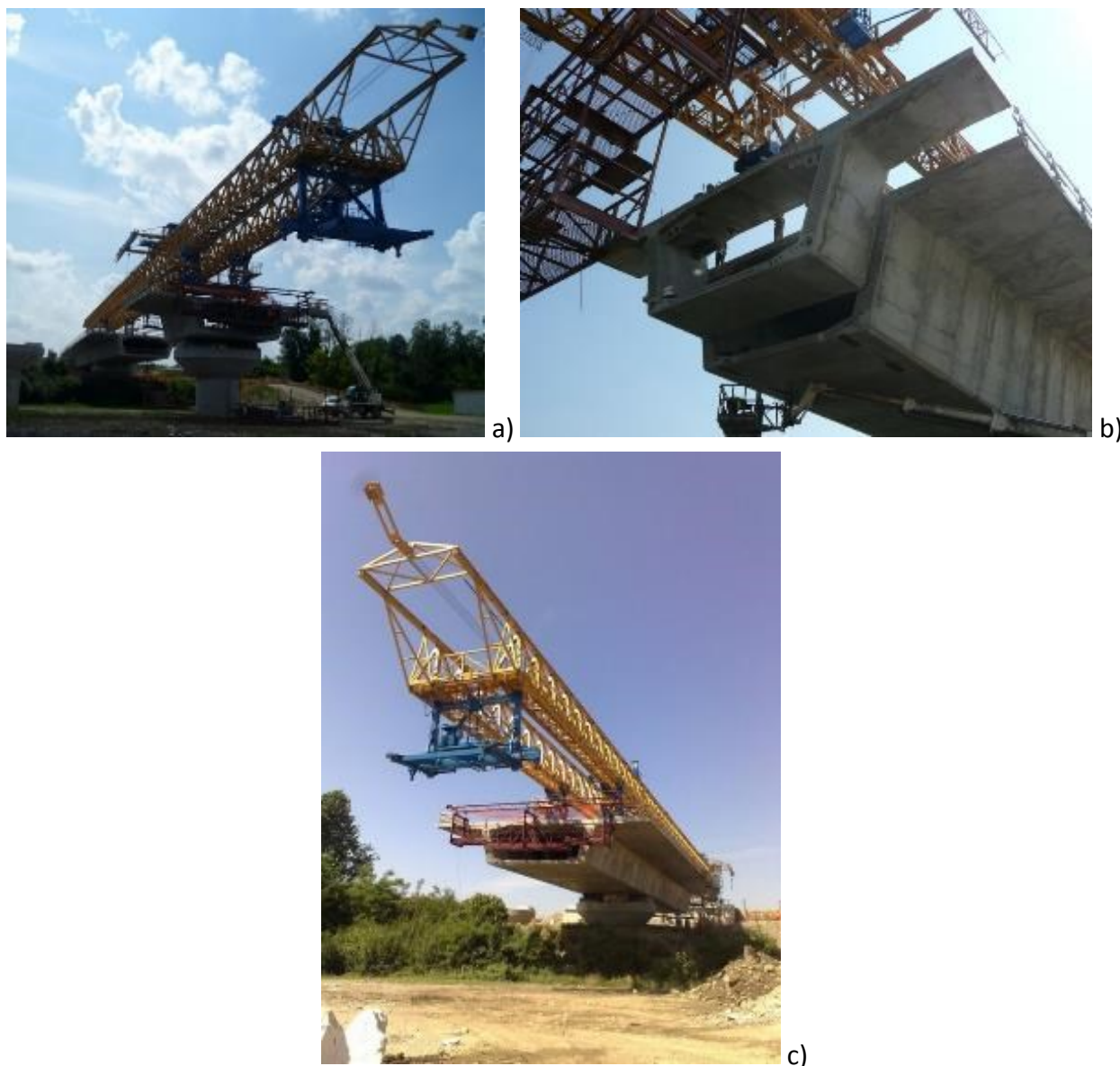
Figura 4.5: fasi di realizzazione di un viadotto con metodo a sbalzo; a) posizionamento del primo concio e delle strutture ausiliarie di sostegno; b) dettaglio relativo al posizionamento di un concio; c) visione d'insieme di uno sbalzo già in buona parte realizzato.
