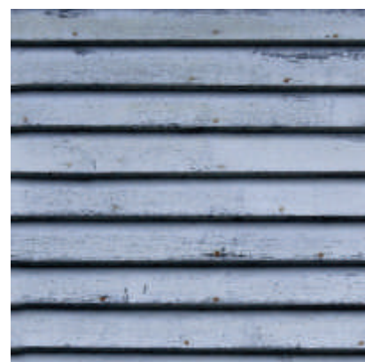
Fig.3.1.84 - Finitura di facciata classica delle case antiche e di utilizzo fino agli anni 80. Rivestimento dato dalla semplice chiodatura di listelli di legno verniciati. Con gli anni abbandonata per evidenti problemi di manutenzione
