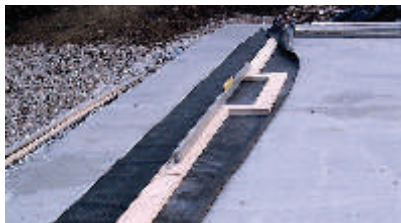
Fig.8.3.7 - "Floating Slab" gettata sul vespaio in ghiaia e separato da un impermeabilizzante che tiene lontano l'umidità
