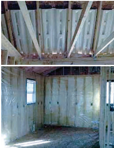
Fig.8.3.13 - Isolamento dato dall'inserimento di pannelli isolanti tra i montanti strutturali di copertura e di parete che determinano la creazione di una serie di ponti termici localizzati
