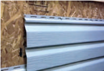
Fig.3.1.86 - Particolare di ancoraggio del rivestimento in pvc sul supporto in OSB mediante sistema a chiodatura
