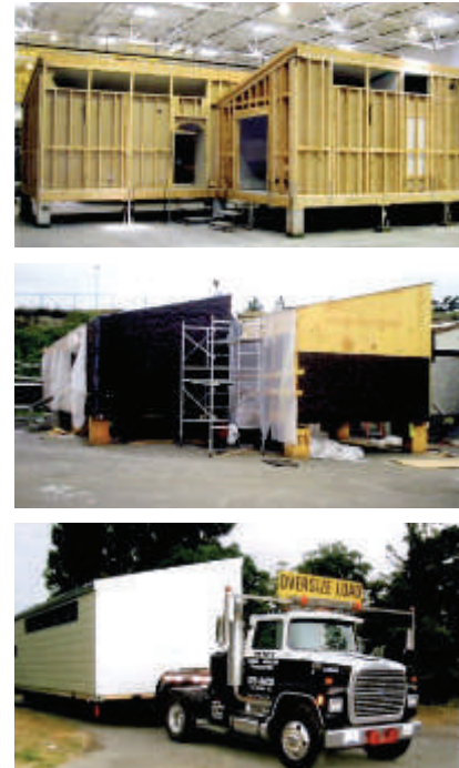
Fig.6.2.11 - Immagini del processo costruttivo completo di tutte le finiture in stabilimento e trasporto in cantiere
