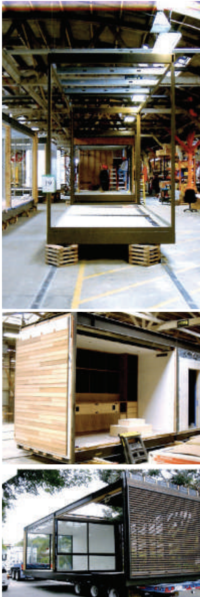
Fig.6.2.18 - Foto del processo realizzativo e del trasporto dei moduli prefabbricati della Desert House
