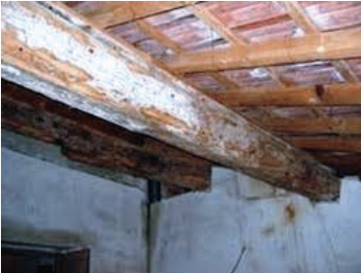
Fig.3.2.5 - Foto particolari di attacchi biologici a travi lignee in una classica casa a Balloon Frame
