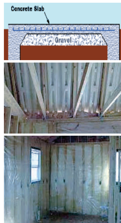
Fig.4.3.2 - Immagini di costruzione di una tradizionale Balloon Frame Home in cui emerge la grossa presenza di ponti termici dovuti al modello costruttivo di montanti lignei di 5cm posti ad interassi di 40cm
