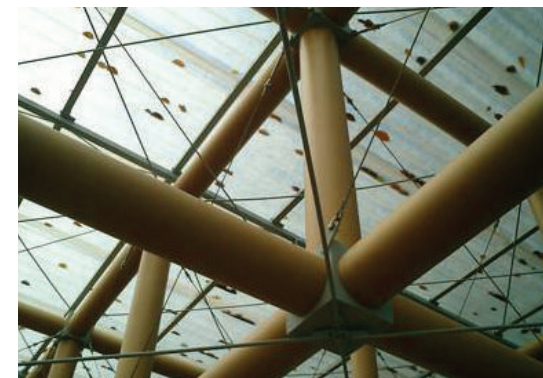
Fig. 2.1.9 _ Particolare della struttura della copertura, Padiglione per la Biennale di Singapore, Shigeru Ban
