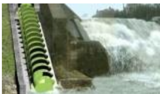
Fig. 5.8: impianto idroelettrico a Vetto (Bologna) 39
