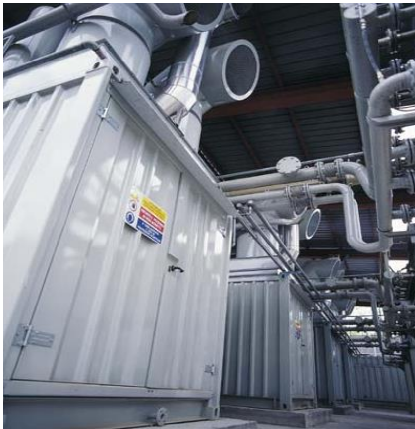
Figura 13 - Impianto biogas ECONORD
