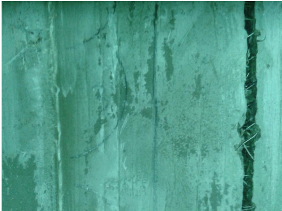
Figura 5. 60 - Formazione di una nuova fessura, provino T condizione WATER 6 mesi
