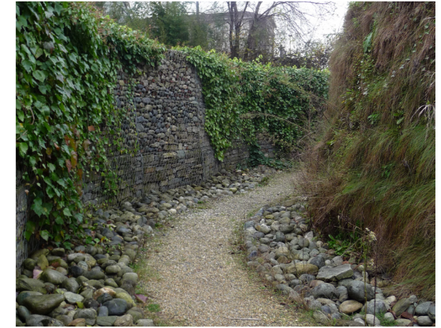
Installazione nel giardino
