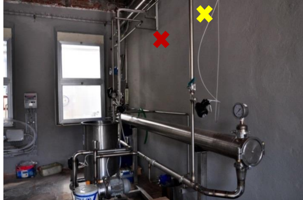
Figura 2.6 Modulo di Ultra Filtrazione installato presso PLAC
