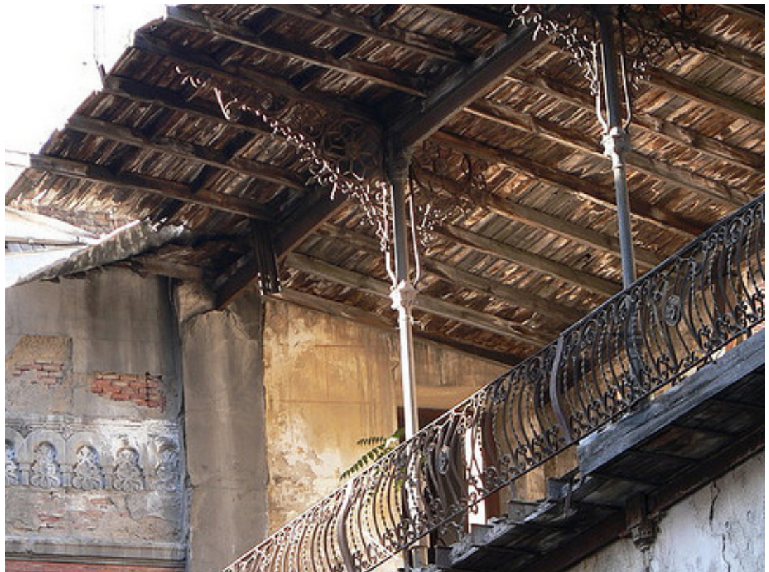
IGOR G.M., Dettaglio delle ringhiere in ferro battuto e delle colonne di ghisa del quarto livello del frontone , 28 aprile 2008.
