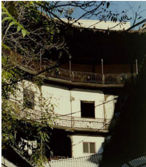
Foto del degrado dello stato di fatto.
