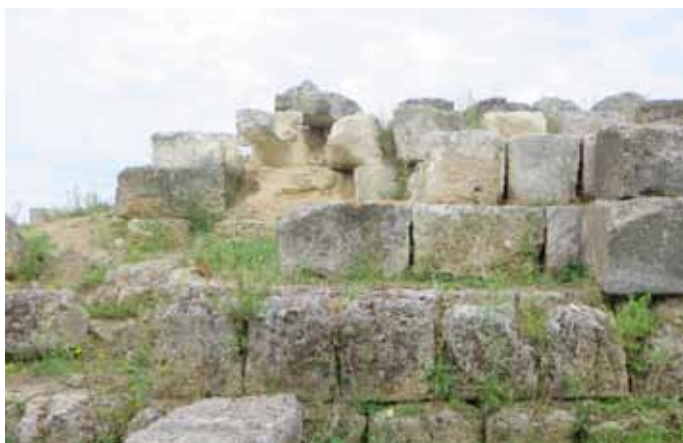
Fig.128 Alcuni conci in Macco presentano due fenomeni in atto: forte disgregazione ed erosione.
