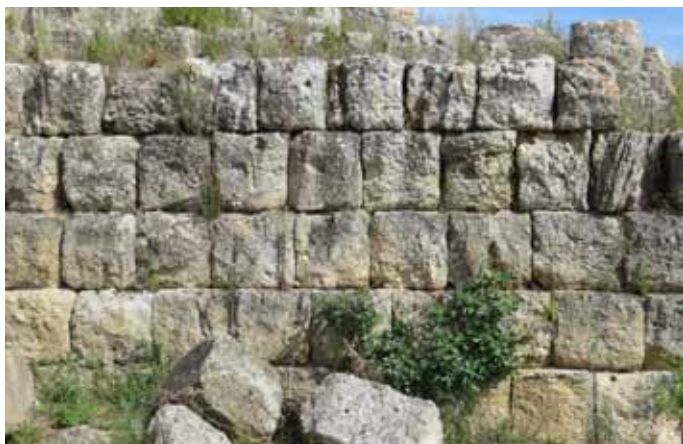
Fig.126 Le piante arboree con l'ispessimento delle radici tra gli interstizi delle pietre provocano danni meccanici alla muratura
