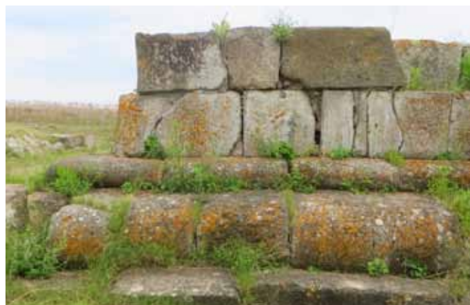
Fig.129 A nord-est, il Nenfro presenta fratture verticali lungo l'intero blocco e la vegetazione erbacea si insidia tra le pietre.
