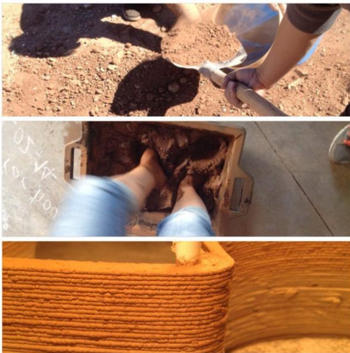
Illustrazione 77: processo di impasto ed estrusione di argilla, dopo estrazione del materiale direttamente in loco, oggetto di realizzazione di un progetto wasp in Marocco
